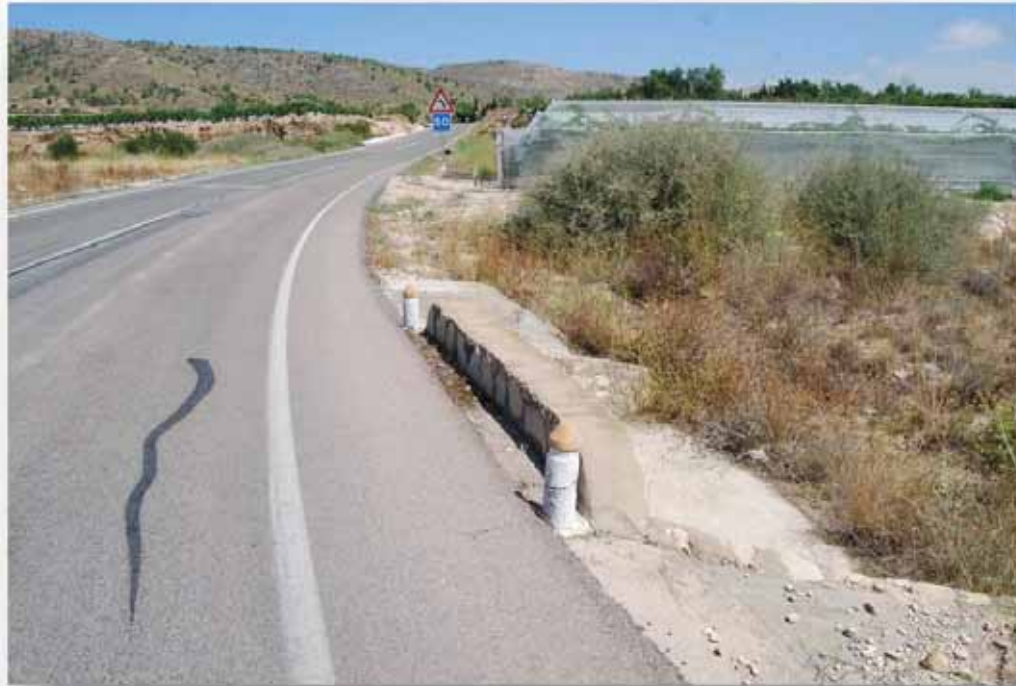
Foto nº 3. Vista del estado actual de la tajea situada en el P.K. 0+410
