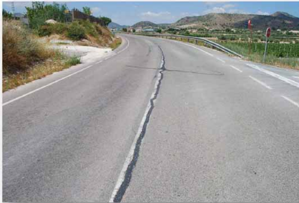
Foto nº 1. Vista estado del firme en el P.K. 1+480.
