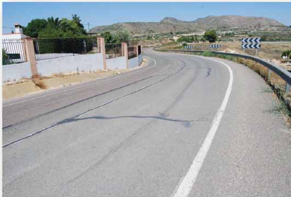
Foto nº 2. Vista del estado actual del firme en el P.K. 1+800.
