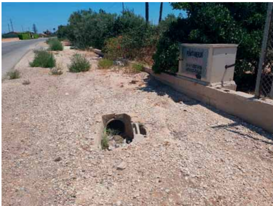
Pk 12+440, arqueta rota. Se prevé desplazamiento y ejecución de nueva arqueta
