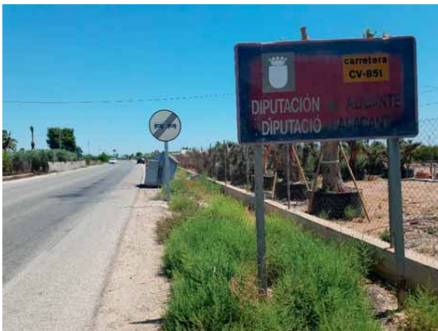
Afecciones a cartelería y contenedor de RSU. PK 11+580
