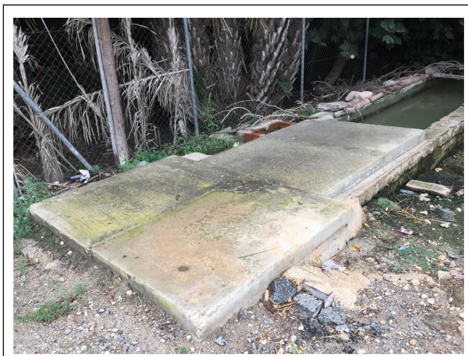
Foto 28: Acequia de riego afectada parcialmente en el PK 9+150
