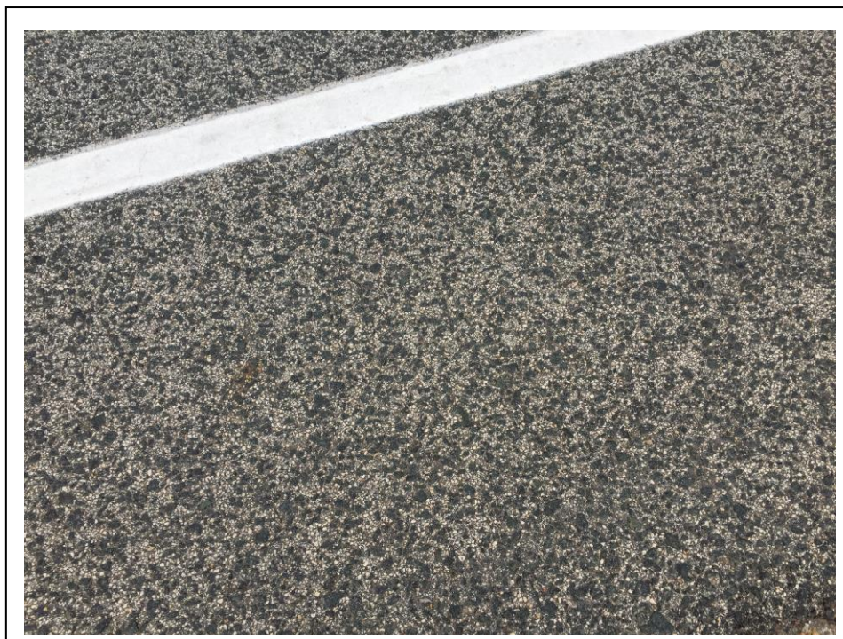
Foto 32: Detalle del estado actual del firme de calzada en la actuación
