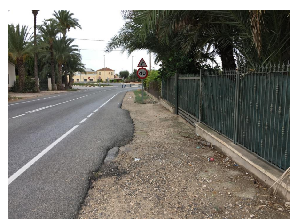
Foto 29: Tramo final del margen afectado en el PK 9+170
