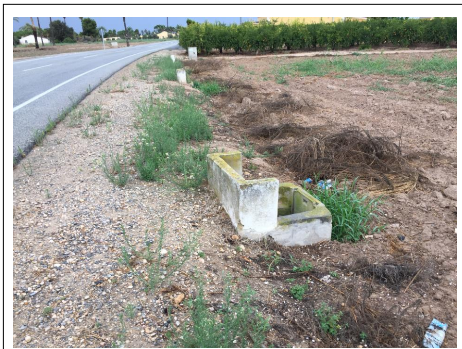
Foto 12: Detalle de las arquetas existentes en el margen de la carretera afectadas por la actuación en el PK 8+120
