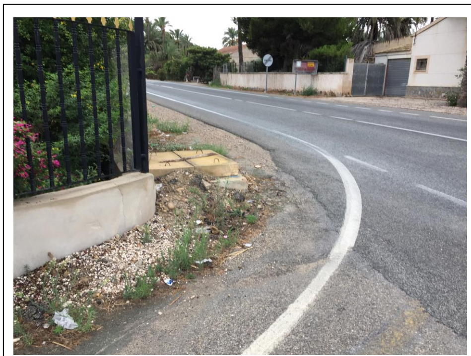
Foto 30: Vista de la arqueta afectada en el PK 9+200.
