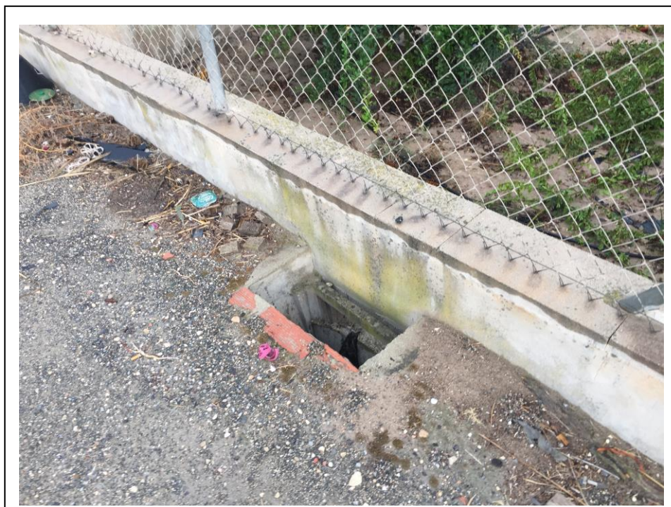
Foto 22: Detalle de arqueta de riego existente
