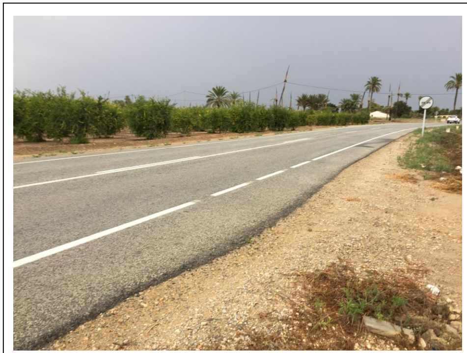
Foto 11: Estado actual de la calzada en el PK 8+060
