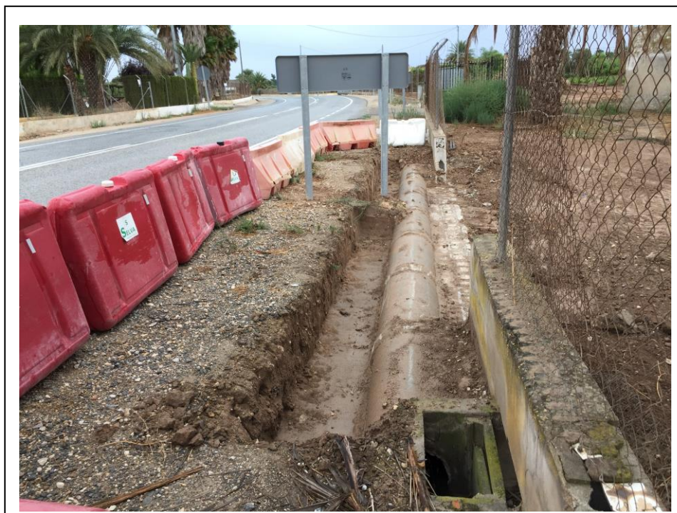
Foto 16: Detalle de la tipología de la conducción de riego existente en la zona.
