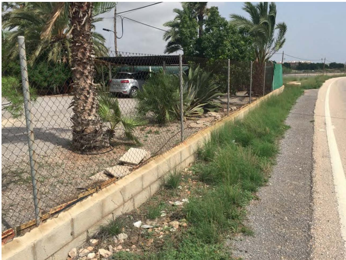
Cerramiento afectado por la ampliación de la plataforma
