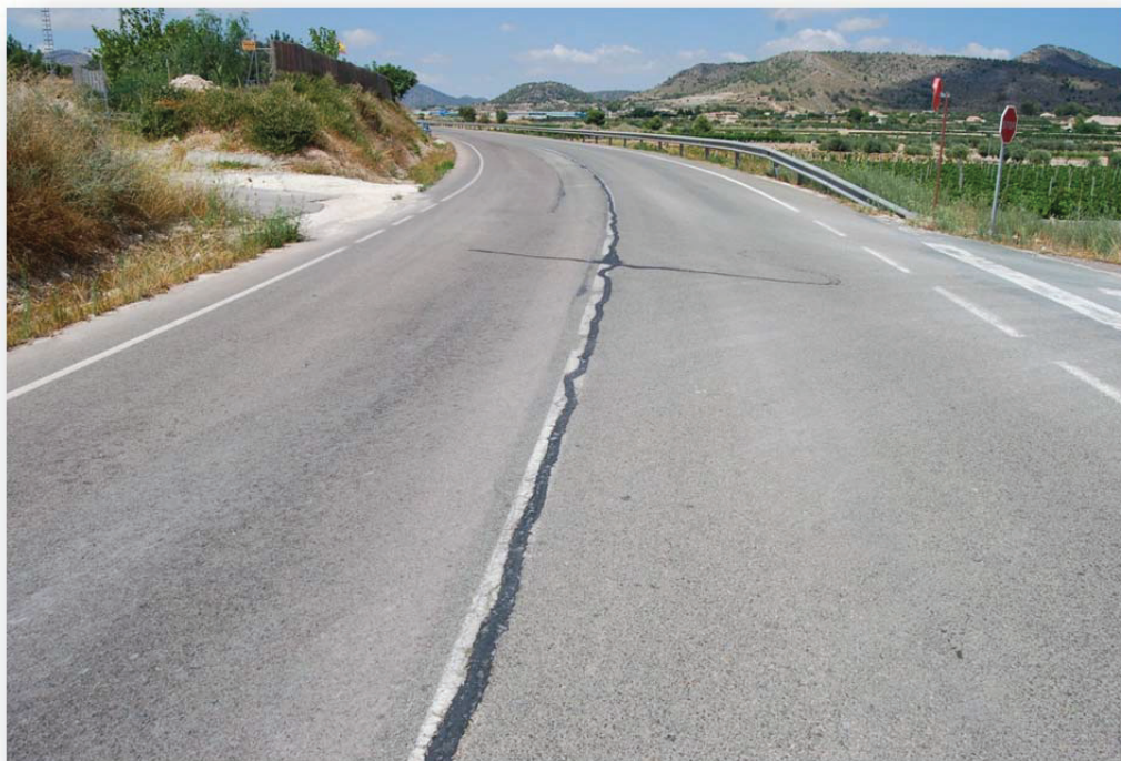
Foto nº 1. Vista estado del firme en el P.K. 1+480.
