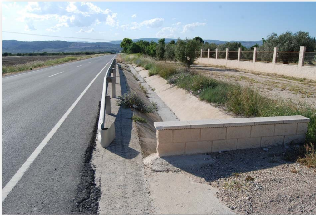
Foto nº 3. Vista del estado actual de la cuneta de hormigón en el P.K. 1+800
