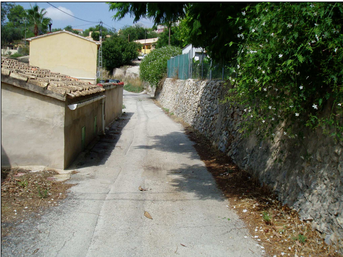
Fotografía n°8: Antes de ejecutar el nuevo firme se deberá despejar y limpiar la totalidad de la plataforma.
