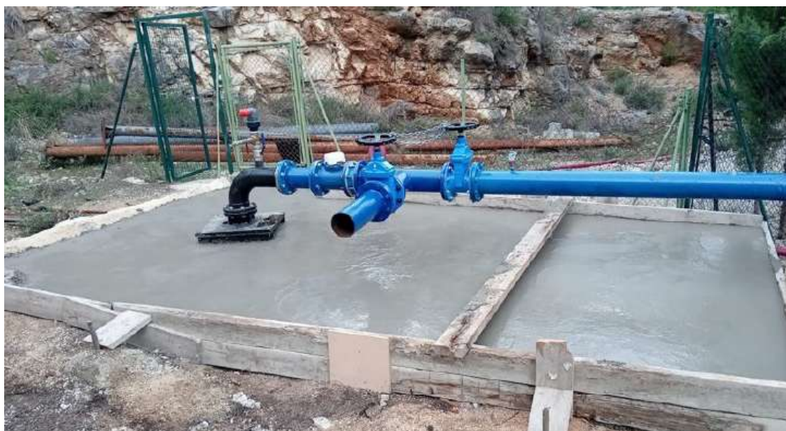
Ilustración 7 Ejemplo de Brocal y piezas hidráulicas de instalación similar.
