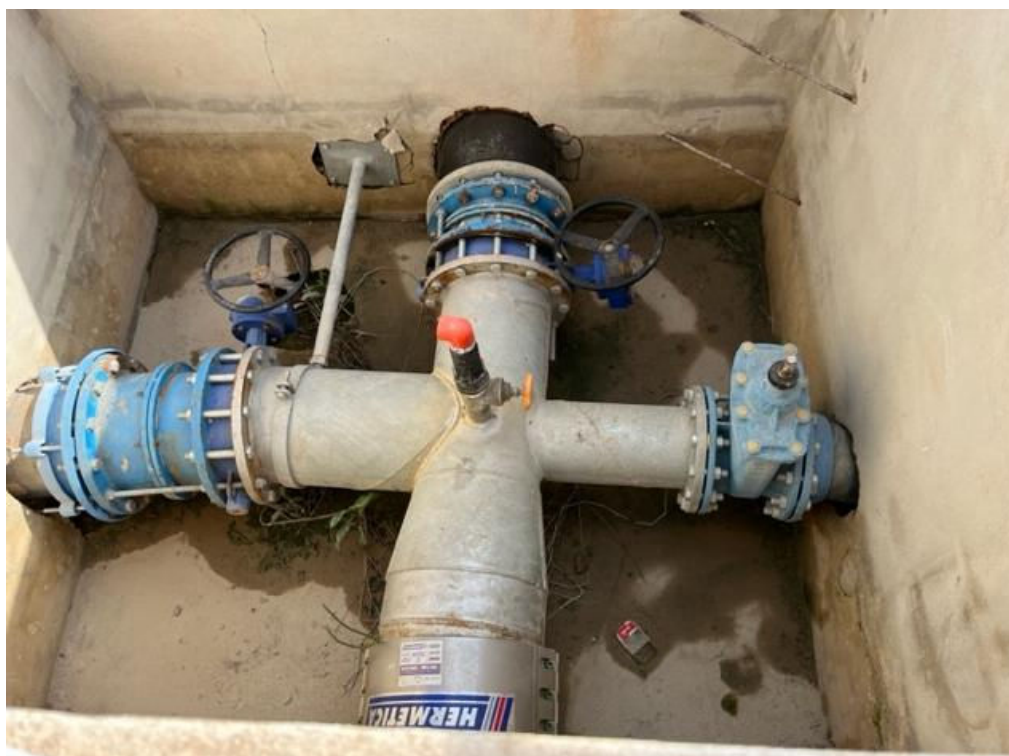
FOTOGRAFÍA N° 6: ARQUETA DE DISTRIBUCIÓN. FINAL DE LA CONDUCCIÓN A REPARAR. ESTA ARQUETA HAY QUE DEMOLERLA Y VOLVERLA A CONSTRUIR.
