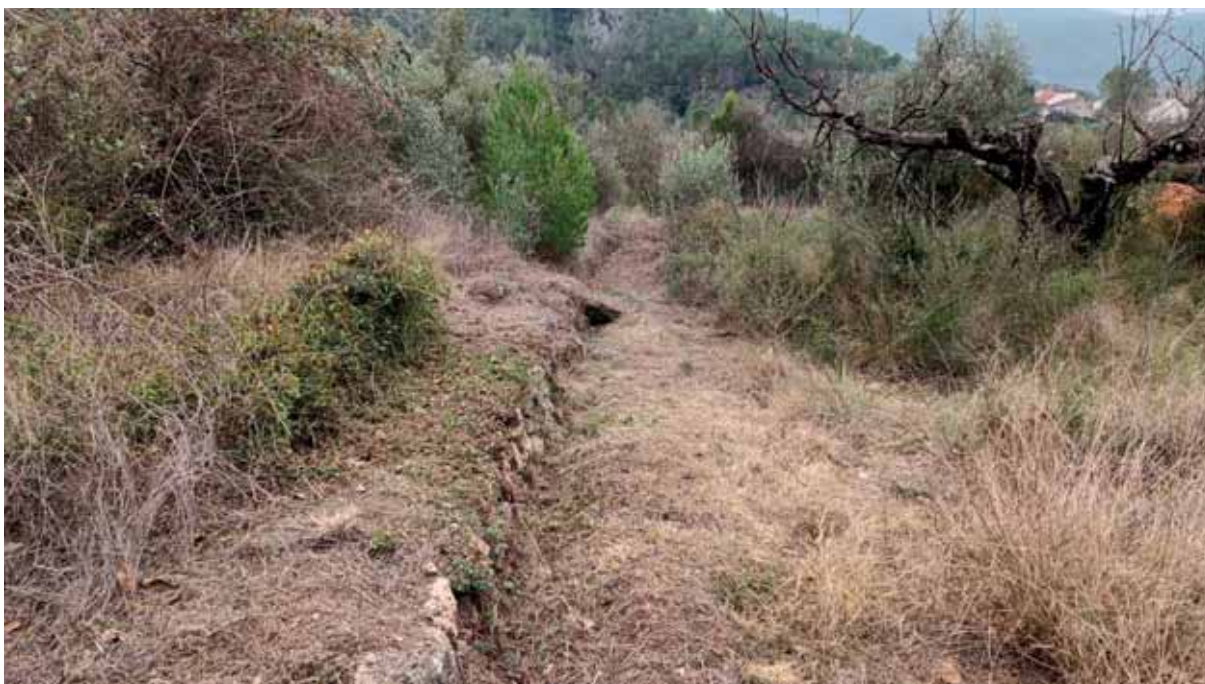
Foto 2: fotografía de un tramo de la acequia Deveses, con excesiva vegetación y mal estado.
