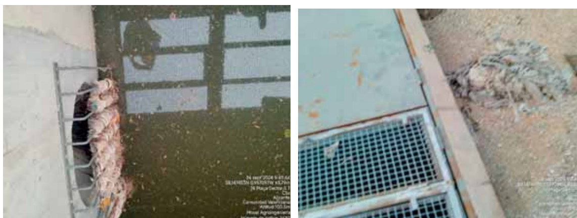
Imagen 5. Vista de sólidos que obturan el sistema de pluviales.
