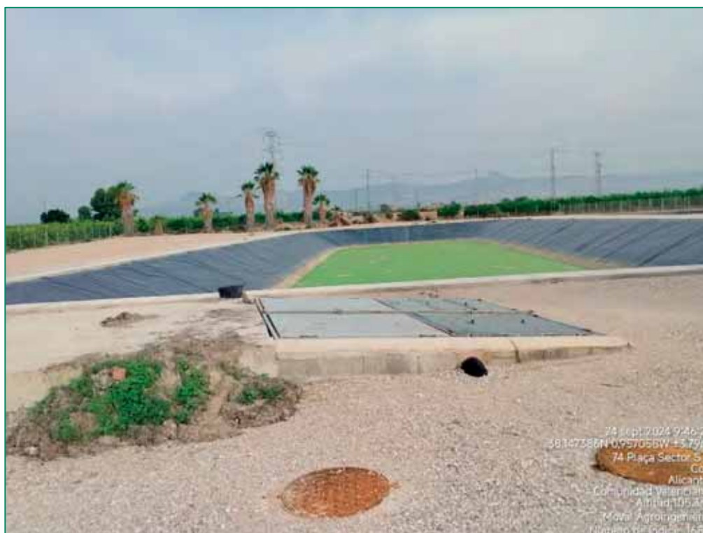
Figura 6. Arqueta de recepción de las aguas de las pluviales
