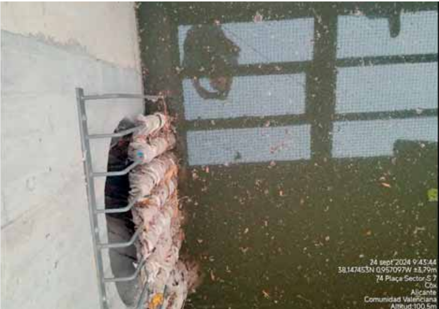
Ilustración 7: Estado actual de la reja de desbaste
