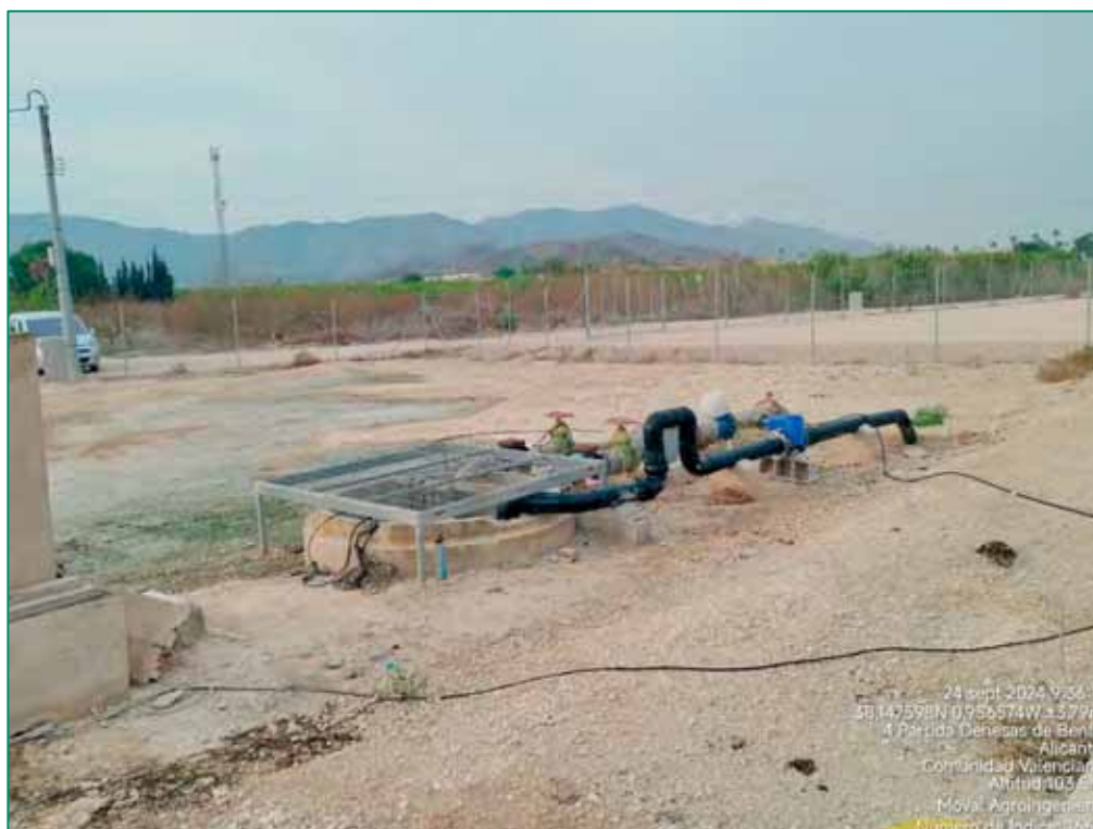
Figura 4. Bombeo de las aguas regeneradas
