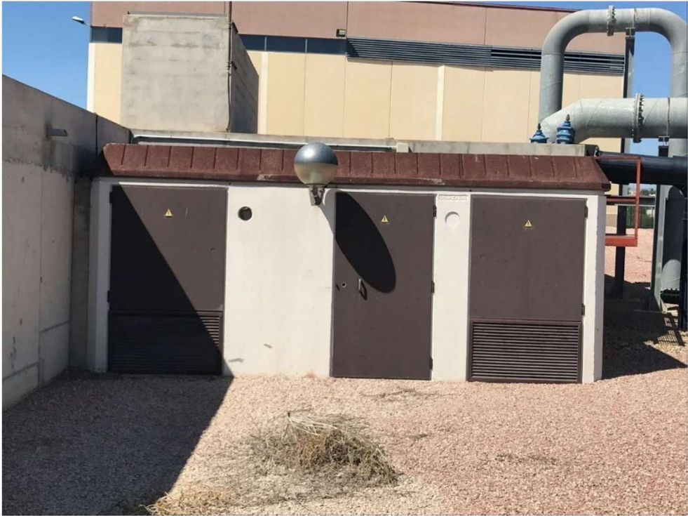
Ilustración 5. Centro de transformación al que sustituir con el grupo. Utilizaremos el cuadro de baja para la alimentación de una bomba
