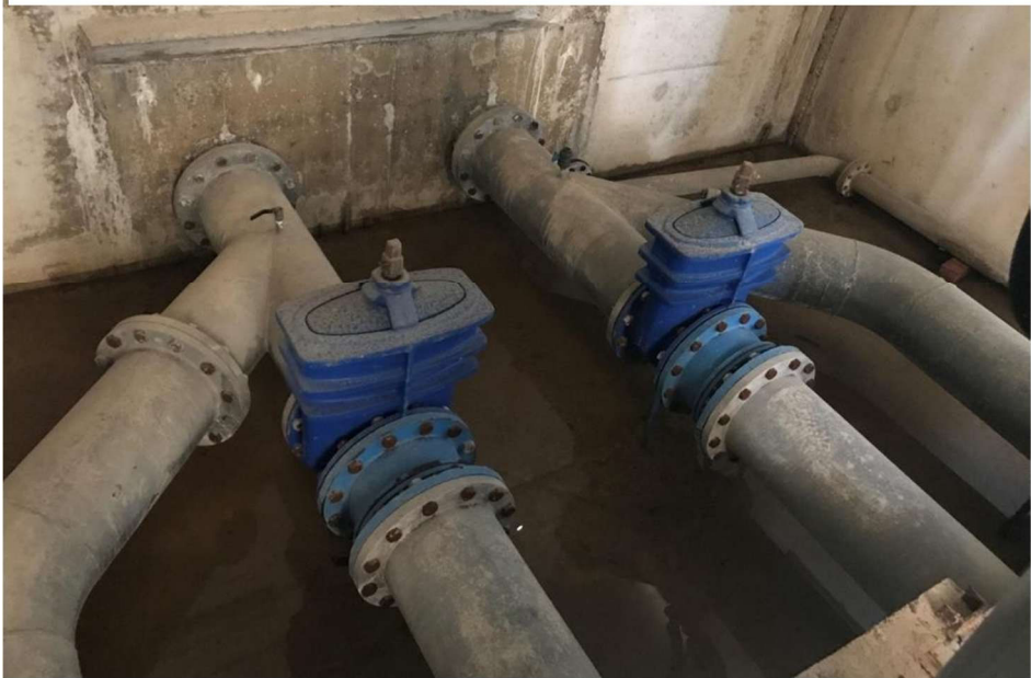
Ilustración 6. Válvulas en cámara de bombas
