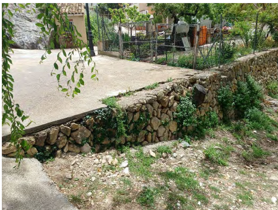
Zona con riesgo de caída en altura
