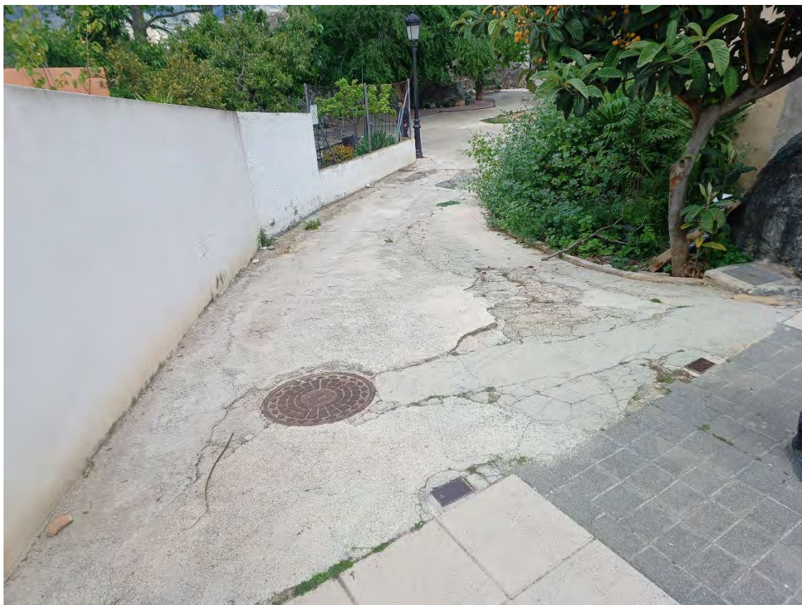
Último tramo de pavimento de calle de acceso en mal estado
