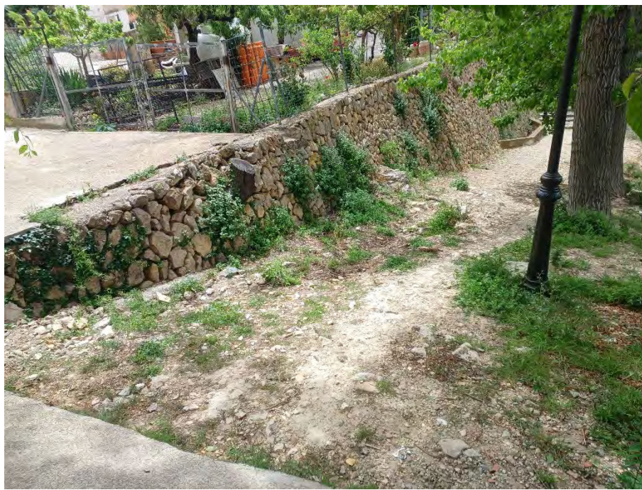
Acceso inferior con erosión por escorrentía superficial
