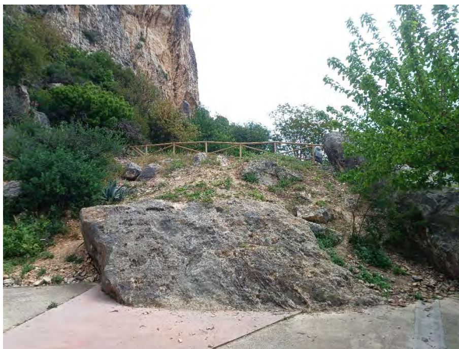
Presencia de pequeños desprendimientos en taludes
