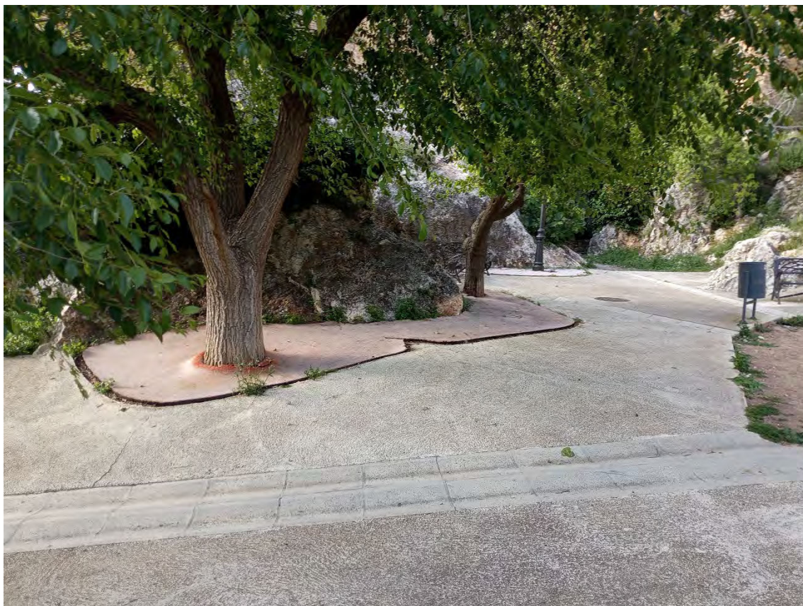
Áreas de caucho innecesarias en mal estado
