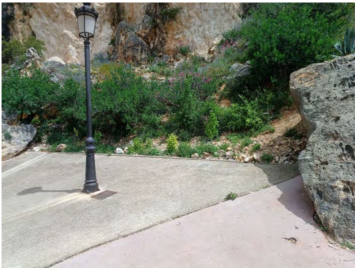
Presencia de desprendimientos en taludes
