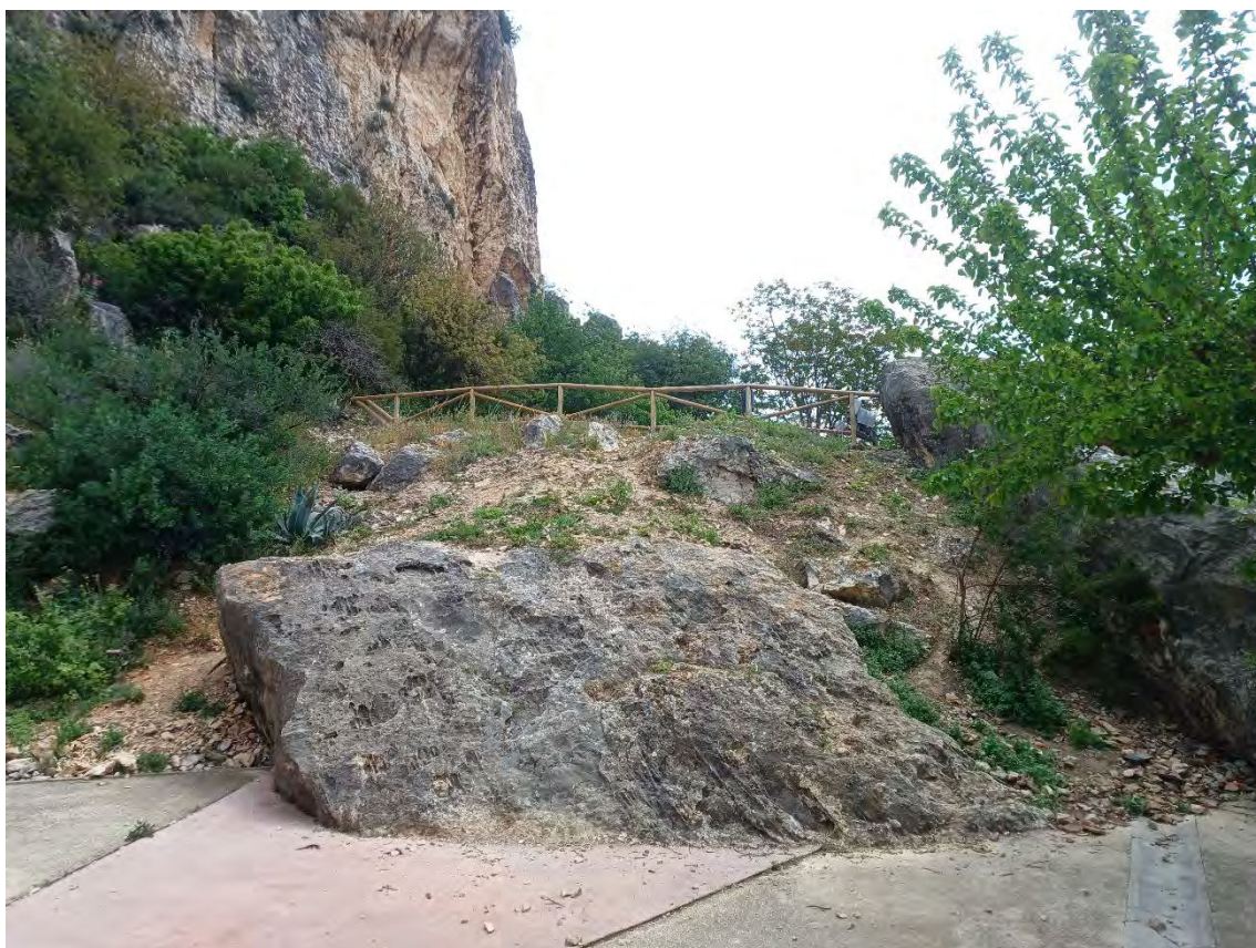
Presencia de desprendimientos en taludes
