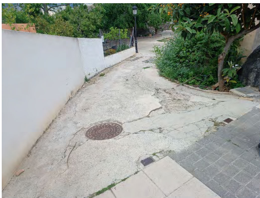
Pavimento de acceso en mal estado de conservación
