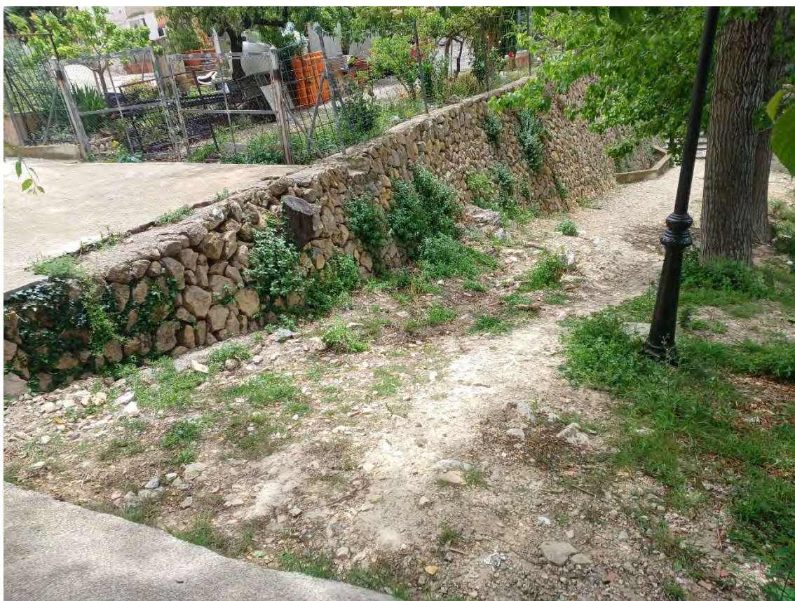
Vial inferior de acceso en mal estado
