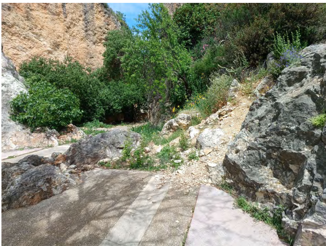
Presencia de desprendimientos en taludes
