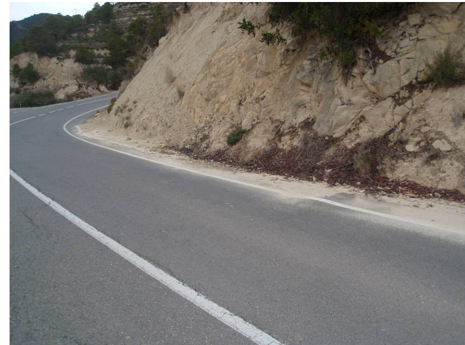
PK 18+280. Derrames en margen derecho. Necesidad de cuenta con murete que contenga dichos derrames.
