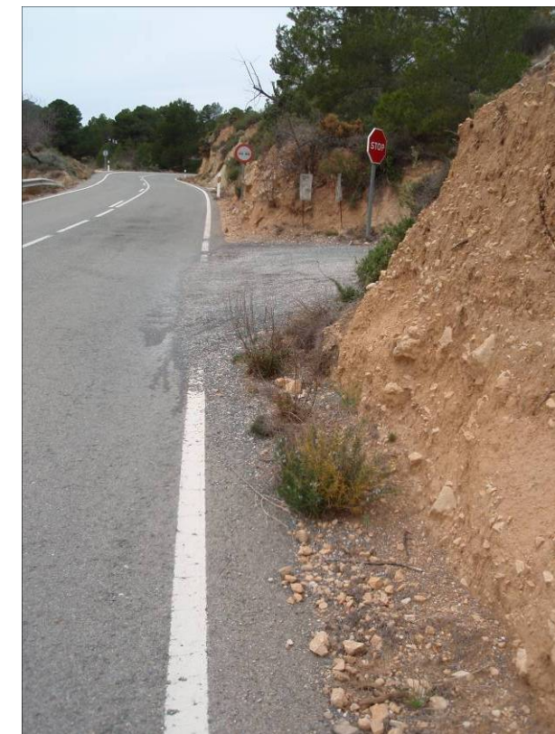
PK 17+770. Entrada a camino. Inexistencia de cunetas y salvacuneta, y pequeños derrames de talud en margen derecho. Necesidad de cuneta y pequeño muro en dicho margen para recoger los materiales de esos pequeños derrames.
