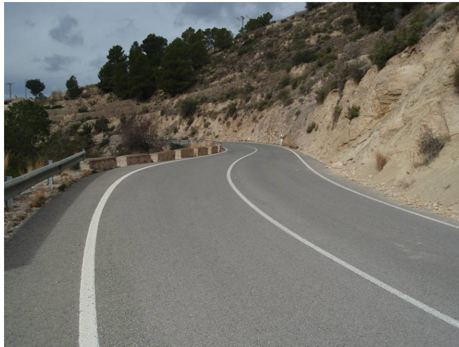
PK 16+900. Existencia de derrames del talud y banquetas con altura insuficiente. Necesidad de cuneta en margen derecho y sustitución de banda y banquetas.
