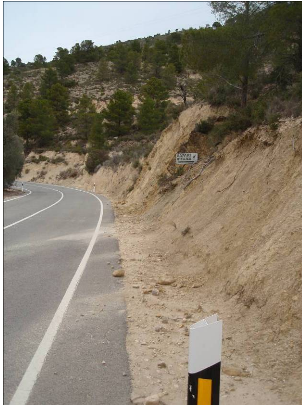
PK 18+100. Derrames de talud. Necesidad de cuneta con murete para contener dichos derrames. Espacio suficiente para la ejecución de dichas obras.
