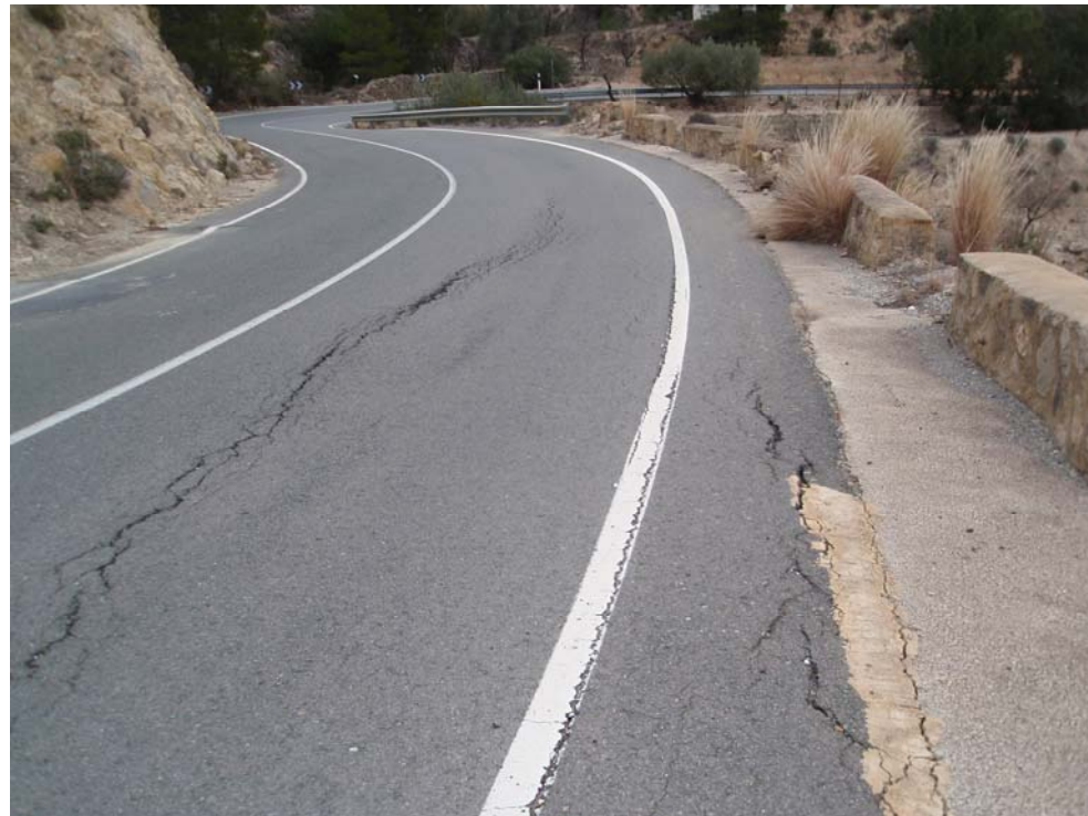
Fotografía 1: Hundimiento localizado en el PK 18+470.
