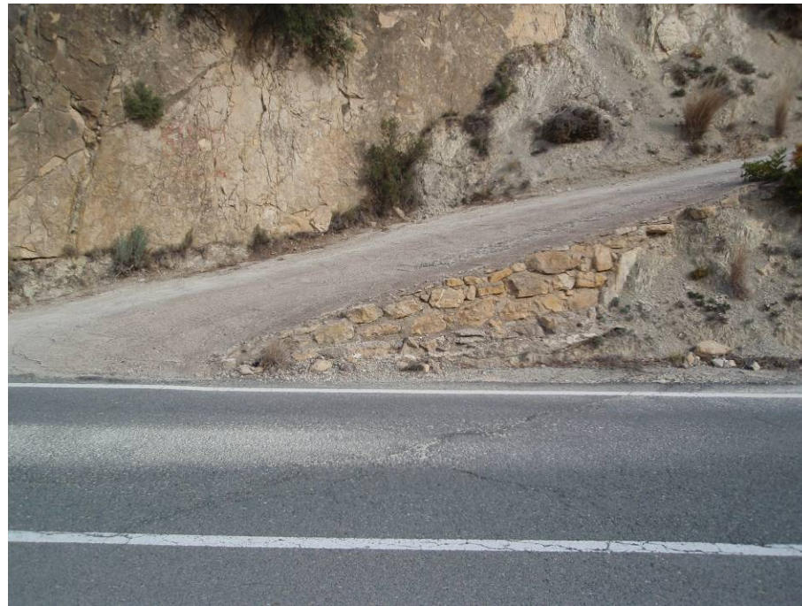
PK 18+730. Entrada a camino con pequeñas grietas superficiales en calzada.
