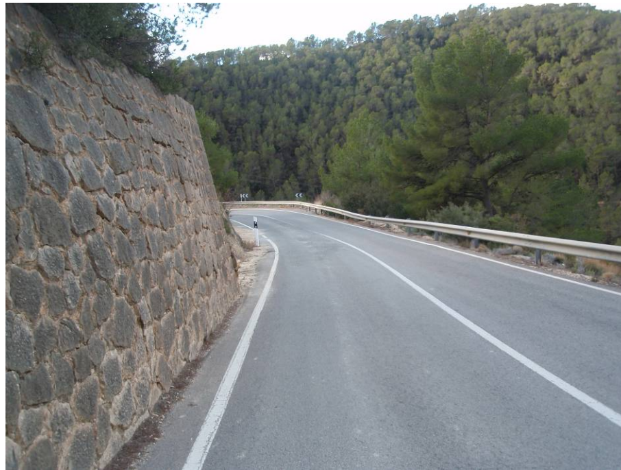
PK 17-280. Muro existente de mampostería en margen derecho muy cerca de la calzada rodada. Imposibilidad de ejecutar cuneta en dicho margen.
