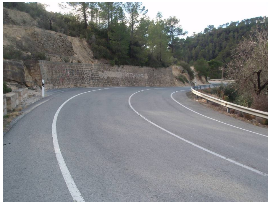
Pk 17-310. Grieta longitudinal en el centro de la calzada. Escasa altura de la barrera de seguridad existente.
