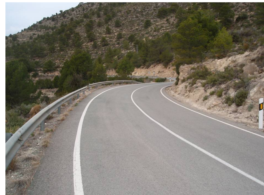
PK 17+420. Barrera de seguridad con escasa altura y huecos entre medias. Espacio suficiente en margen dercho para cuneta con murete de guarda para recoger pequeños derrames del talud.
