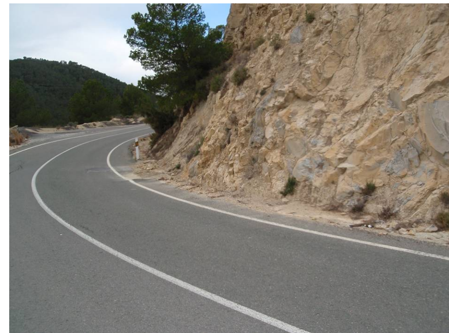
PK 18+460. Cuneta colmatada en margen derecho, con derrames del talud rocoso donde es inviable al excavación. La cuneta en este punto no podrá tener más de 1 metro de anchura.
