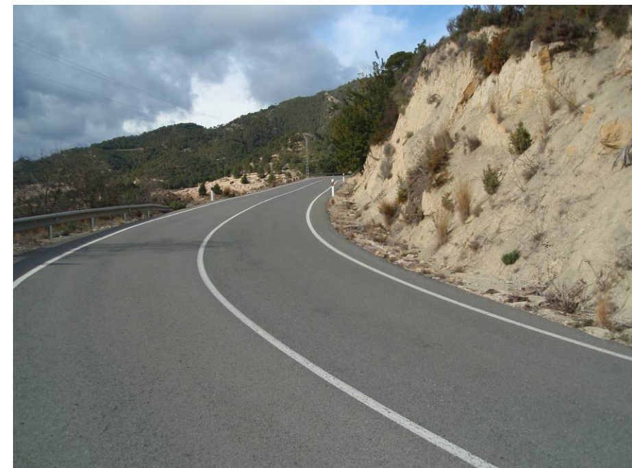
PK 18+840. Ídem respecto a la cuneta del margen derecho.
