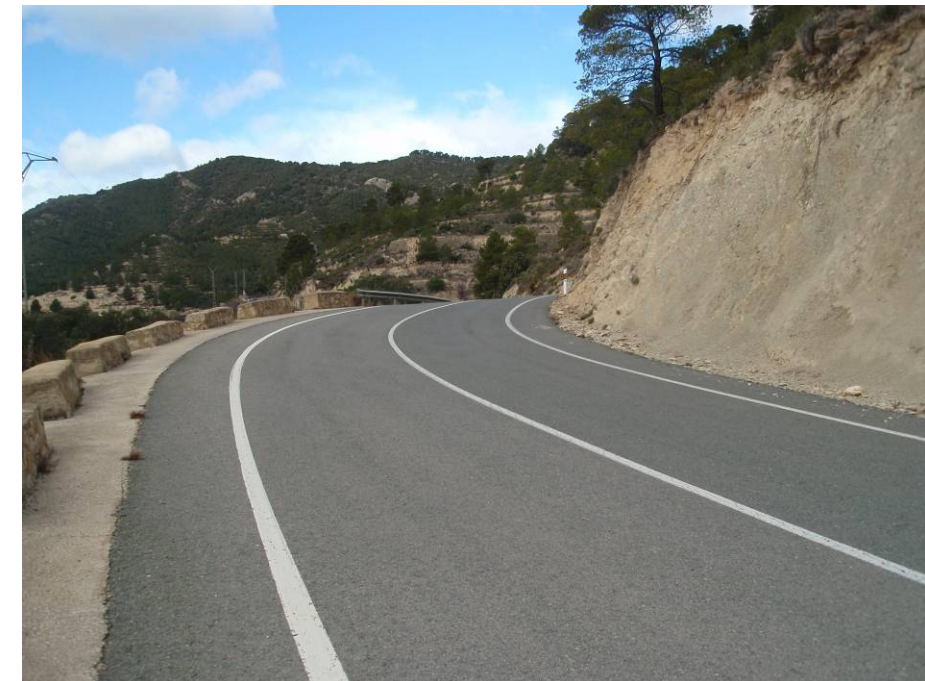
PK 18+600. Pequeños derrames de tierras en margen derecho. Necesidad de cuneta y muro que absorba esos pequeños derrames. Existe espacio para que la cuenta tenga 1 metro de anchura.
