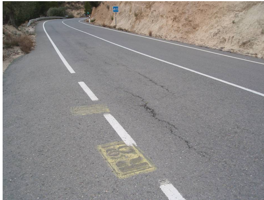
PK 18+310. Erosiones superficiales y grietas longitudinales en el firme asfáltico de la carretera.
