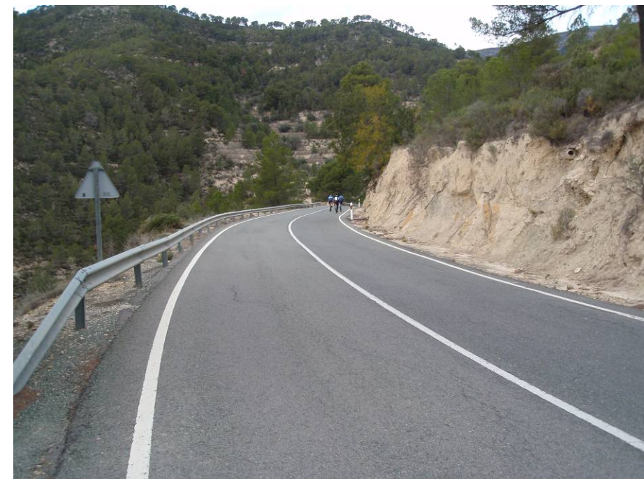
PK 19+040. Barrera de seguridad de escasa altura por rececidos de firme en los últimos tiempos. Espacio en margen derecho para cuneta revesida de hromigón de 1 metro de anchura y muro para recoger los pequeños derrames del talud.
