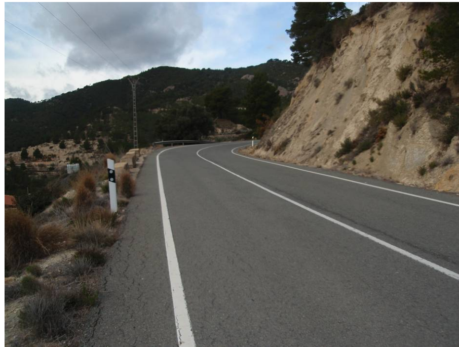
PK 18+900. Ídem respecto a la cuneta del margen derecho. Existencia de grietas longitudinales en la capa asfáltica de la carretera. Banquetas de escasa altura por sucesivos asfaltados de la carretera.
