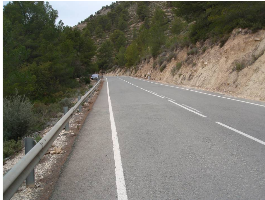
PK 17+540. Derrames de tierras procedentes del talud en margen derecho. Necesidad de cuneta en dicho margen con muro que recoja dichos derrames.
