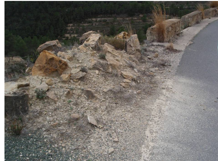
PK 18+445. Banqueta totalmente desintegrada. Banquetas de mampostería a retirar, sistema de contención no homologado.
