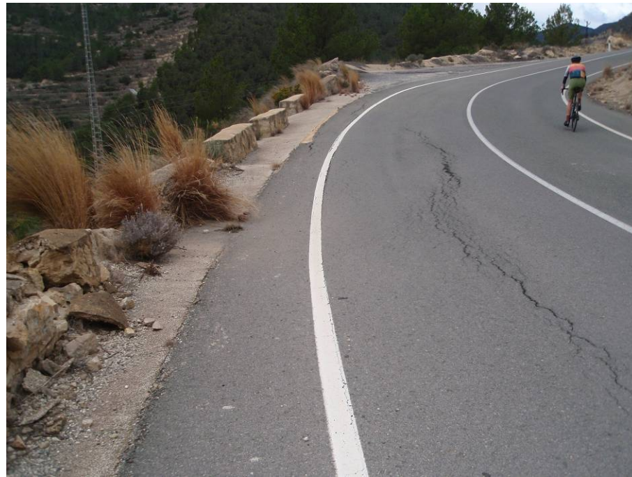
PK 18+480. Hundimiento del firme por fallo del terraplenado. Grietas de varios centímetros de apertura con sensible desplazamiento de la rodadura. Se observan reparaciones puntuales que no han arreglado el problema. Necesidad de un bacheo profundo con restitución completa del firme con ejecución de geotextil apraa evitar filtraciones al fondo del terraplén.
