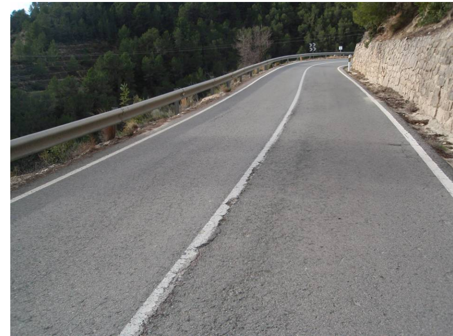
PK 17+130. Grietas longitudinales en firme asfáltico. Escasa altura de la barrera de seguridad y espacio escaso en margen derecho junto a muro de mampostería existente. La cuneta tendrá un ancho menor de 1 metro, terminando en el muro existente.
