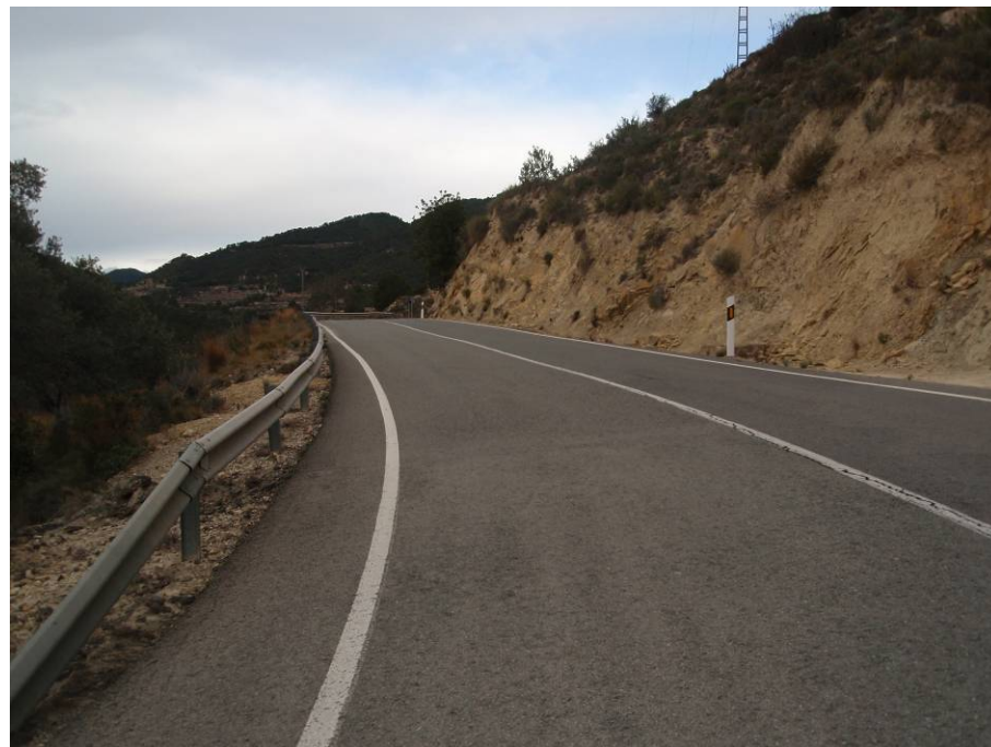
PK 18+180. Grietas longitudinales en eje de la calzada rodada. Obra de drenaje transversal con obra de fábrica sobre rasante de carretera a demoler y balizar. Barrera de seguridad de escasa altura por sucesivos asfaltados de la carretera.
