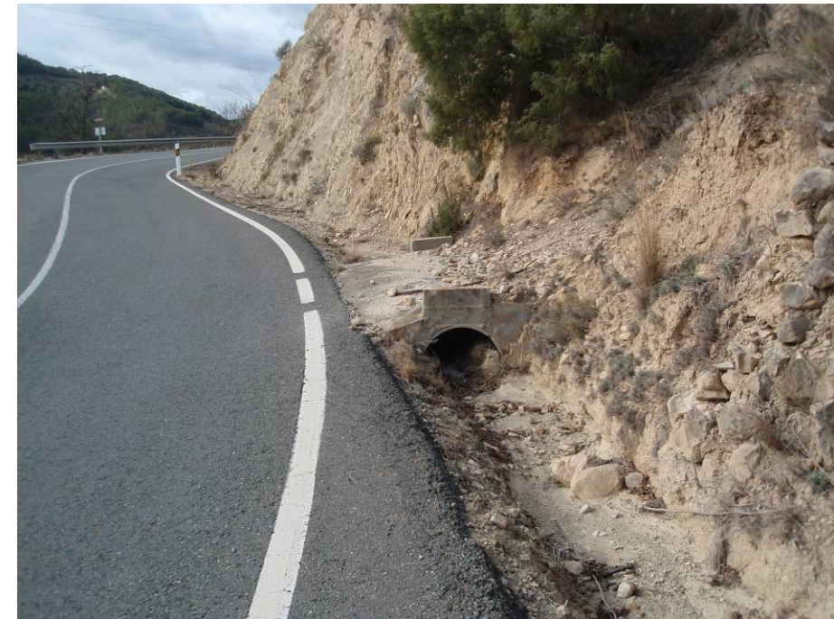
PK 18+770. Paso salvacuneta en entrada a camino particular. Existencia de cunetas en tierraas en magen derecho. Necesidad de revestirlas y contruir murete que recoja los pequeños derames de tierras.
