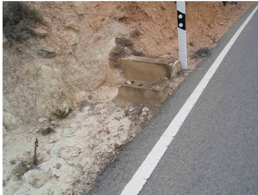
PK 17+800. Detalle de obra de fábrica de drenaje transversal con muros de bloque prefabricado de hormigón y sin protección ni balizamiento. Cuneta en tierras atorada y con derrame de tierras de talud. Necesidad de balizar la obra de fábrica eliminando el muro de bloque prefabricado de hormigón.
