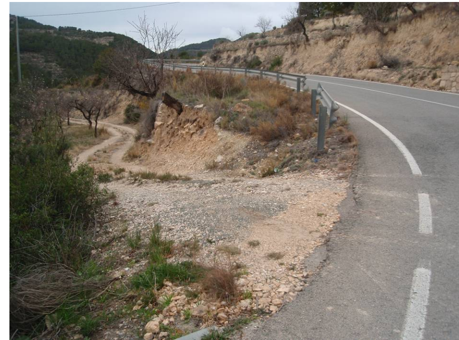
PK 17+330. Barrera de seguridad sin abatimientos. Entrada a camino particular.
