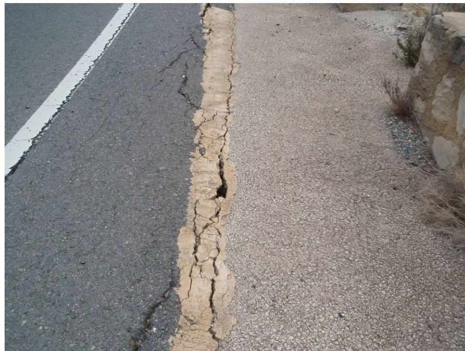
PK 18+480. Detalle de grietas del hundimiento.
