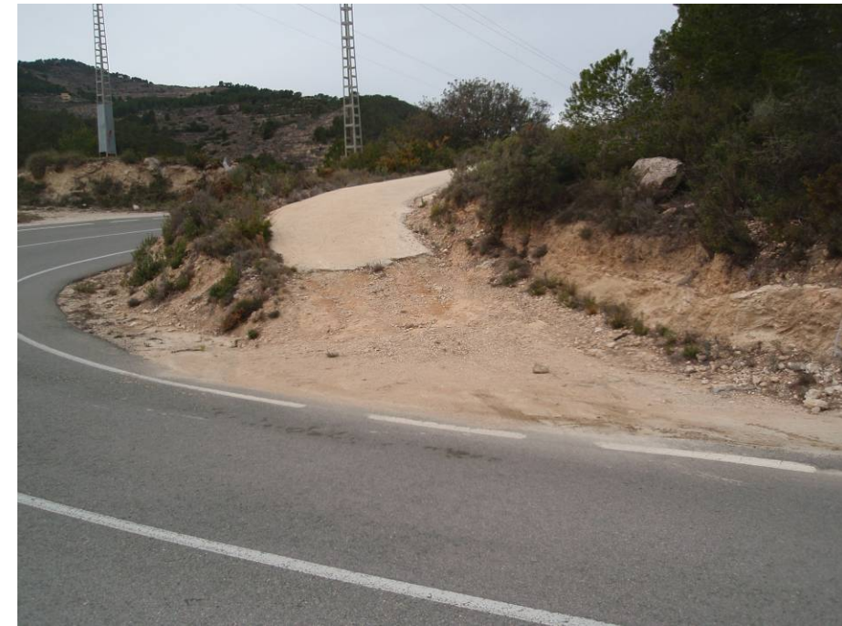
PK 18+010. Entrada a camino con derrame de tierras en borde de carretera que hace que la escorrentía invada la calzada rodada. Necesidad de cuneta en margen derecho y paso salvacuestas en la entrada a camino.
