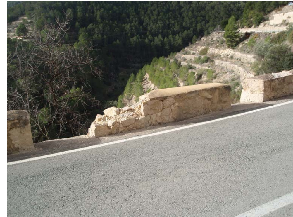
Fotografía 4: Banqueta deteriorada. Sistema de contención no homologado a retirar.
