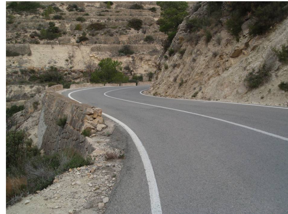
PK 16+720. Banquetas en estado deficiente y con alturas insuficiente por recrecidos de asfaltado. Necesidad de sustitución de banquetas por barrera de seguridad metálica.
