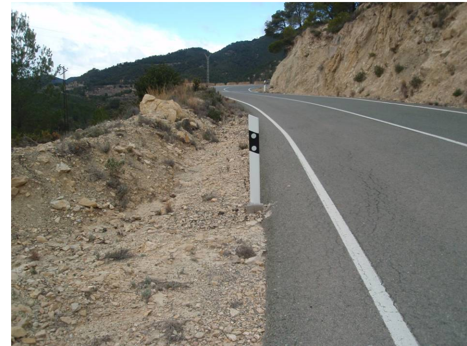
PK 18+525. Grietas longitudinales en el margen izquierdo. Necesidad de cuneta en dicho margen.
