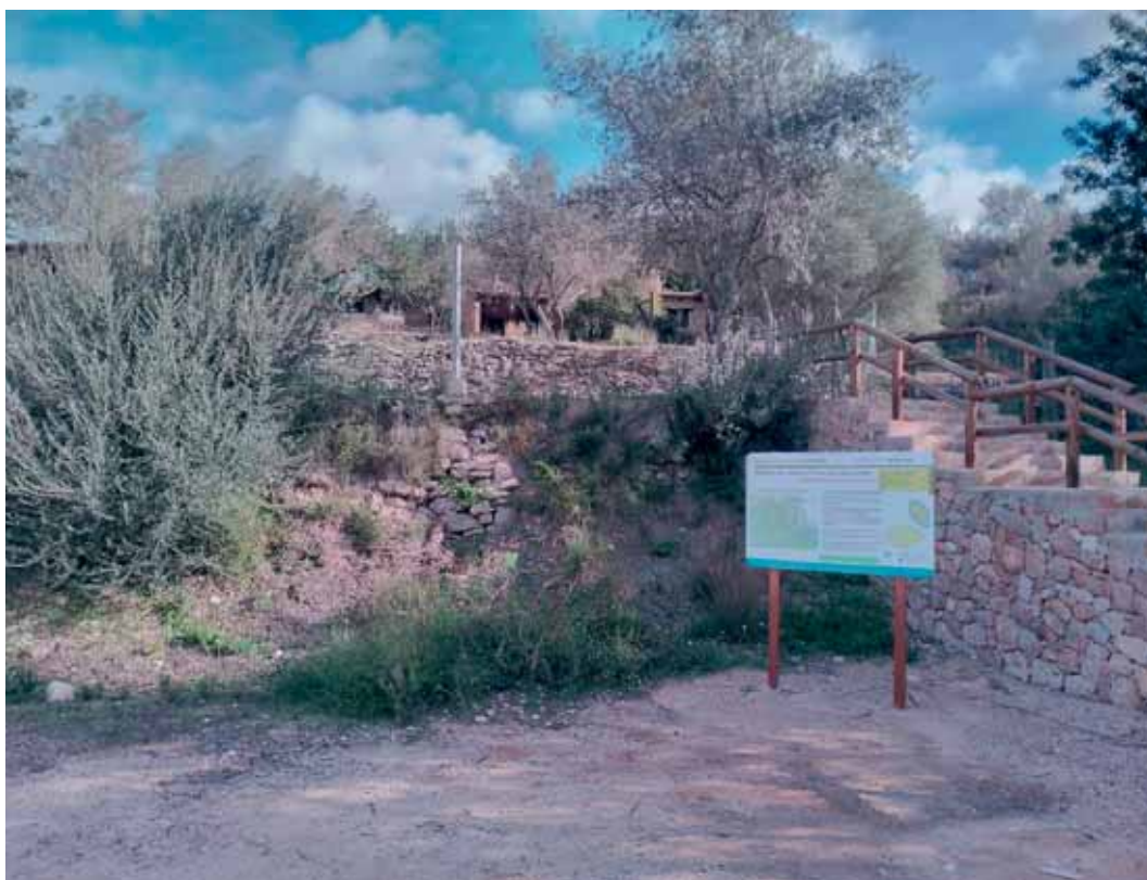
Zona nº06. Zona de aparcamiento. Detalle de tramo con pérdida de muro de sostenimiento
