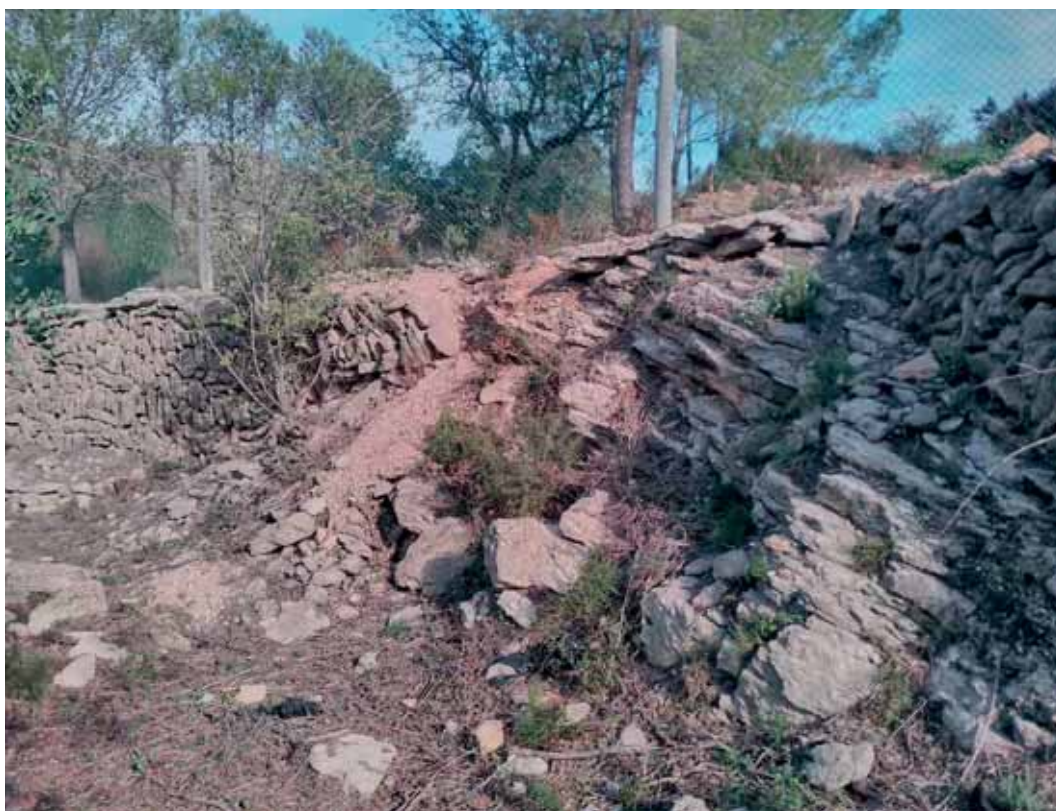
Foto nº16. Zona de terrazas superiores. Tramo donde ha vencido el muro de piedra seca
