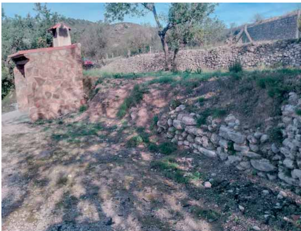
Foto n°18. Acceso superior a cabañas. Tramo donde se ha perdido el muro de piedra seca
