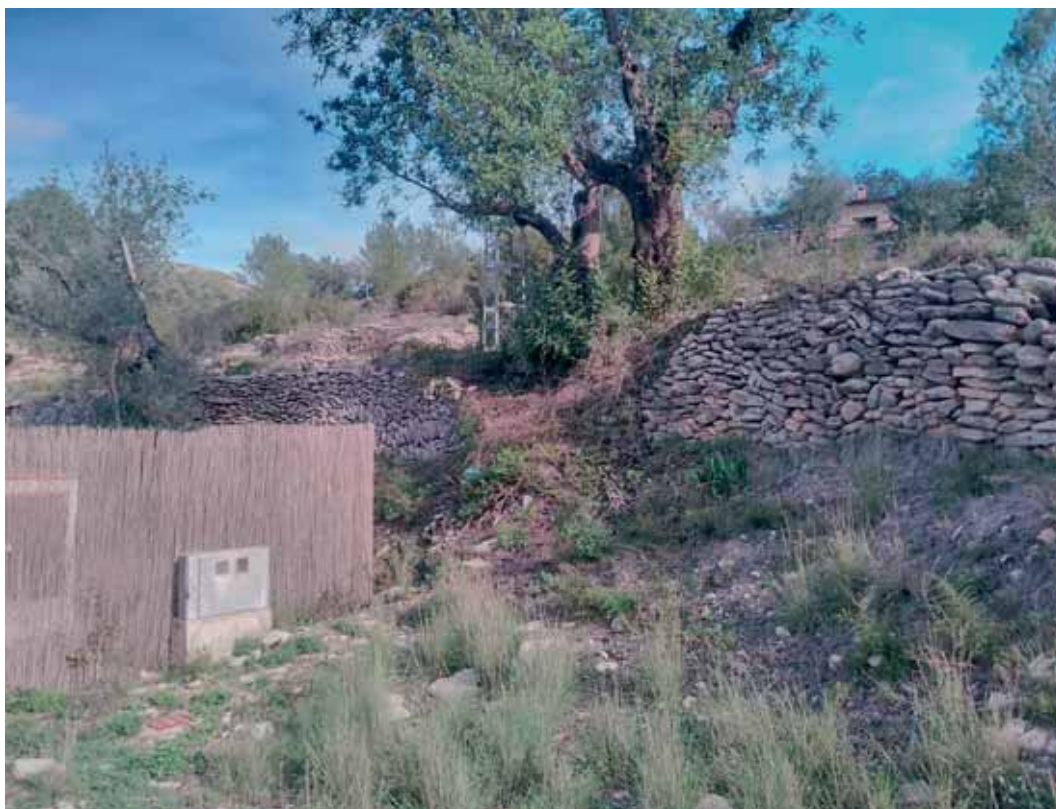
Foto nº13. Zona de aparcamiento. Punto donde el muro ha vencido al empuje de las raíces del árbol
