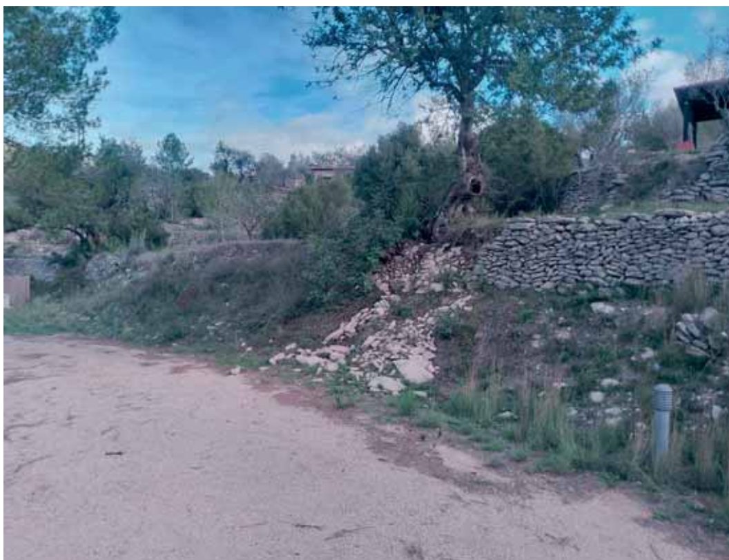
Foto nº02. Zona aparcamiento. Detalle de tramo con pérdida de muro de sostenimiento
