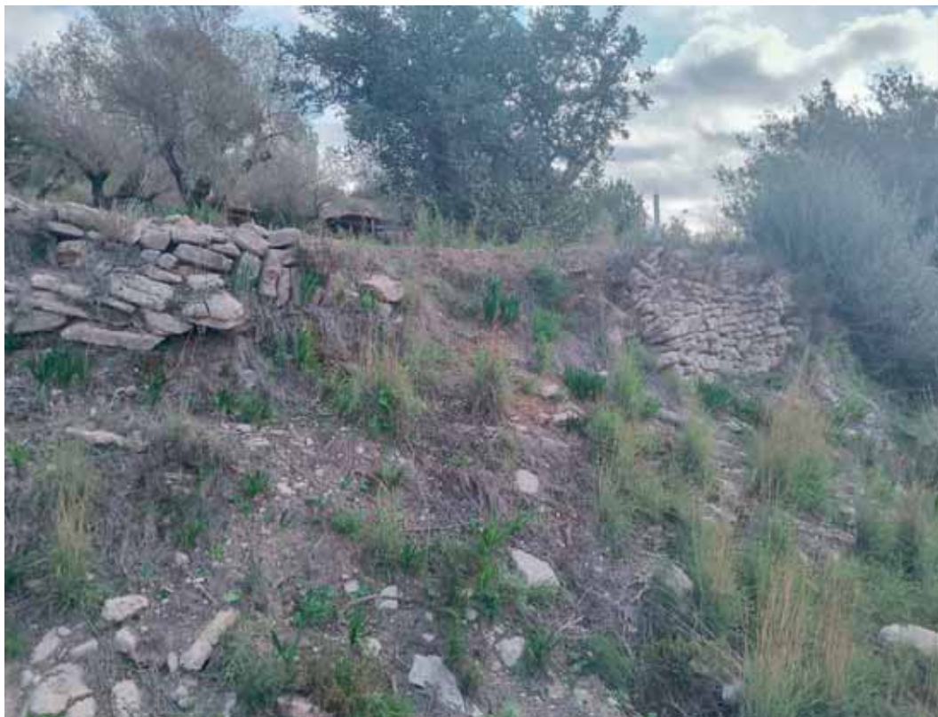
Foto nº05. Zona de aparcamiento. Detalle de tramo con pérdida de muro de sostenimiento
