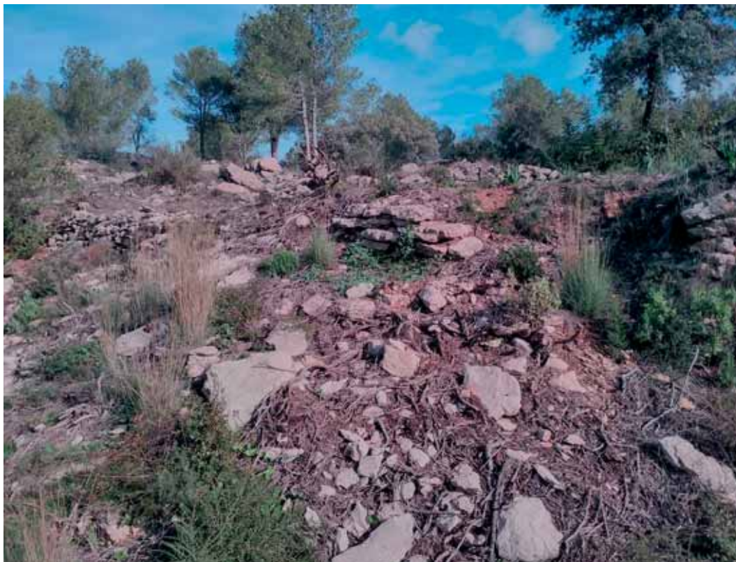
Foto nº09. Zona de aparcamiento. Zona donde se ha perdido el muro de piedra seca
