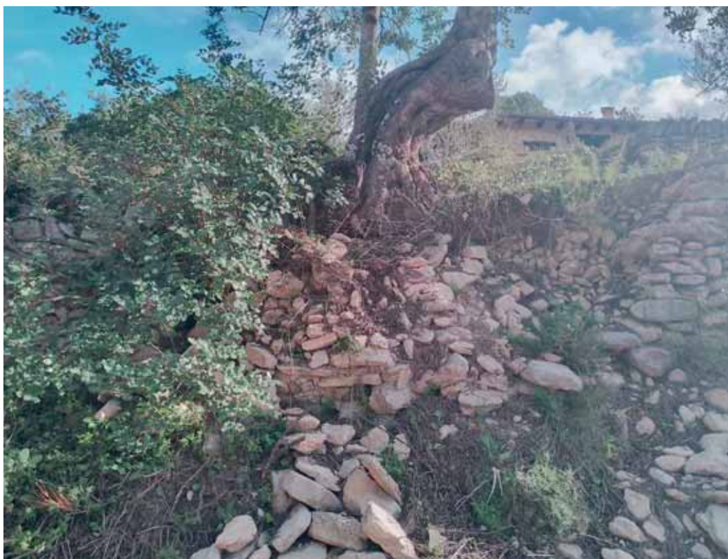
Foto nº12. Zona de aparcamiento. Punto donde el muro ha vencido al empuje de las raíces del árbol
