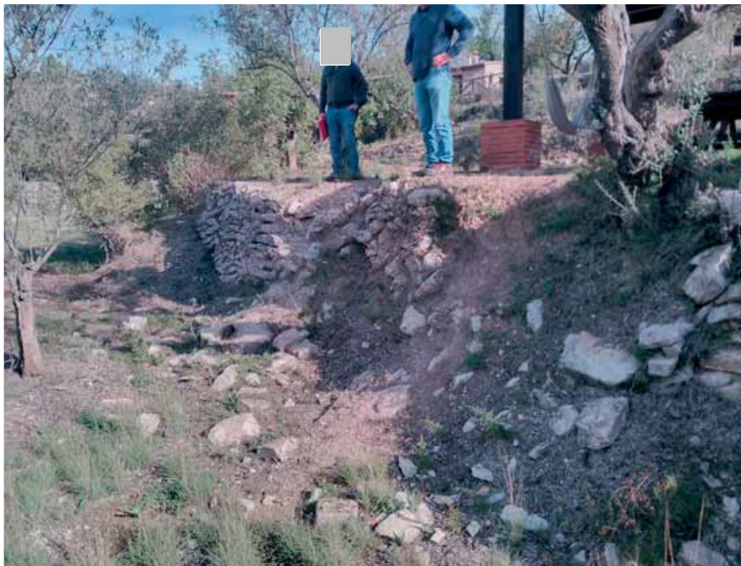
Foto nº15. Zona de terrazas superiores. Tramo donde ha vencido el muro de piedra seca
