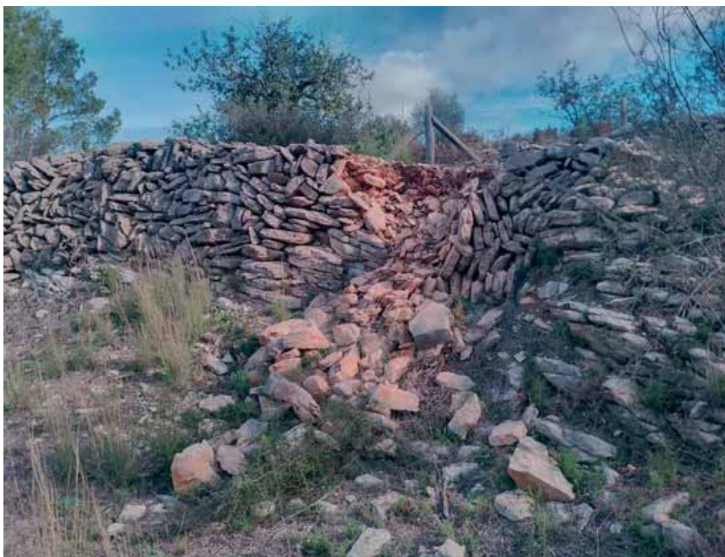
Foto nº14. Zona de terrazas superiores. Punto donde ha vencido el muro de piedra seca
