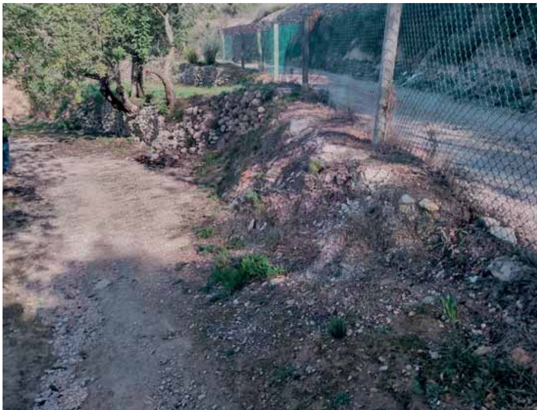
Foto n°17. Acceso superior a cabañas. Tramo donde se ha perdido el muro de piedra seca
