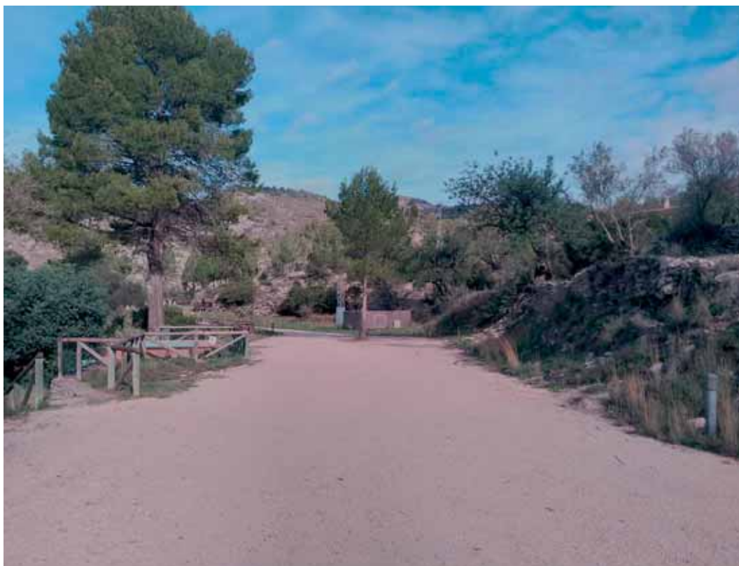
Foto nº01. Zona aparcamiento. A la derecha se observa zona abancalada con pérdida de muro de sostenimiento
