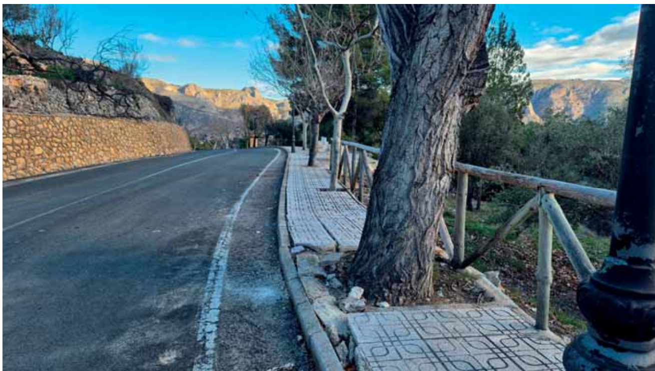
FOTO 3. Presencia de árbol de gran porte interrumpiendo la acera
