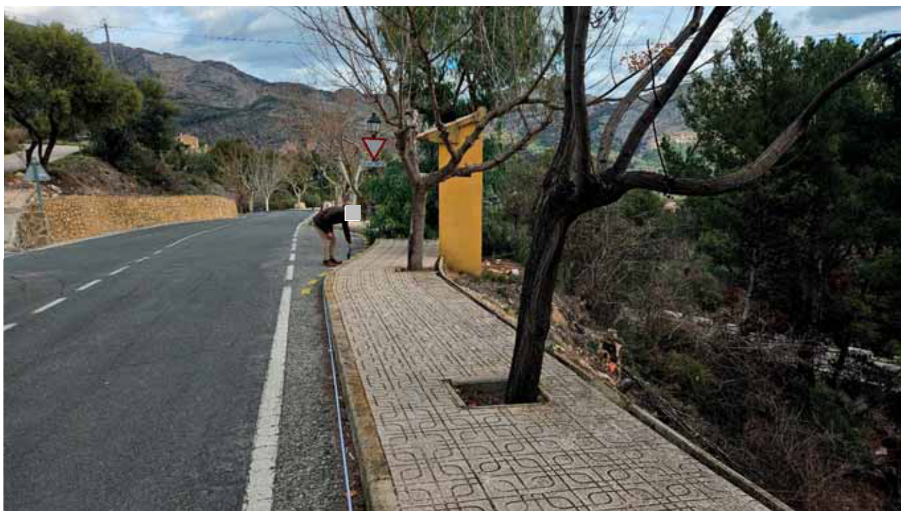
FOTO 5. Vista del estado de la acera. Se observa como el bordillo trasero se ha desplazado debido a la cercanía del talud existente.
