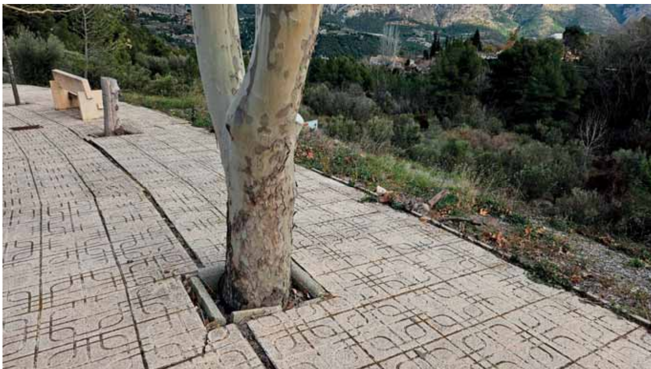
FOTO 7. Vista del estado de la acera. La presencia de raíces ha provocado roturas en el pavimento de acera.
