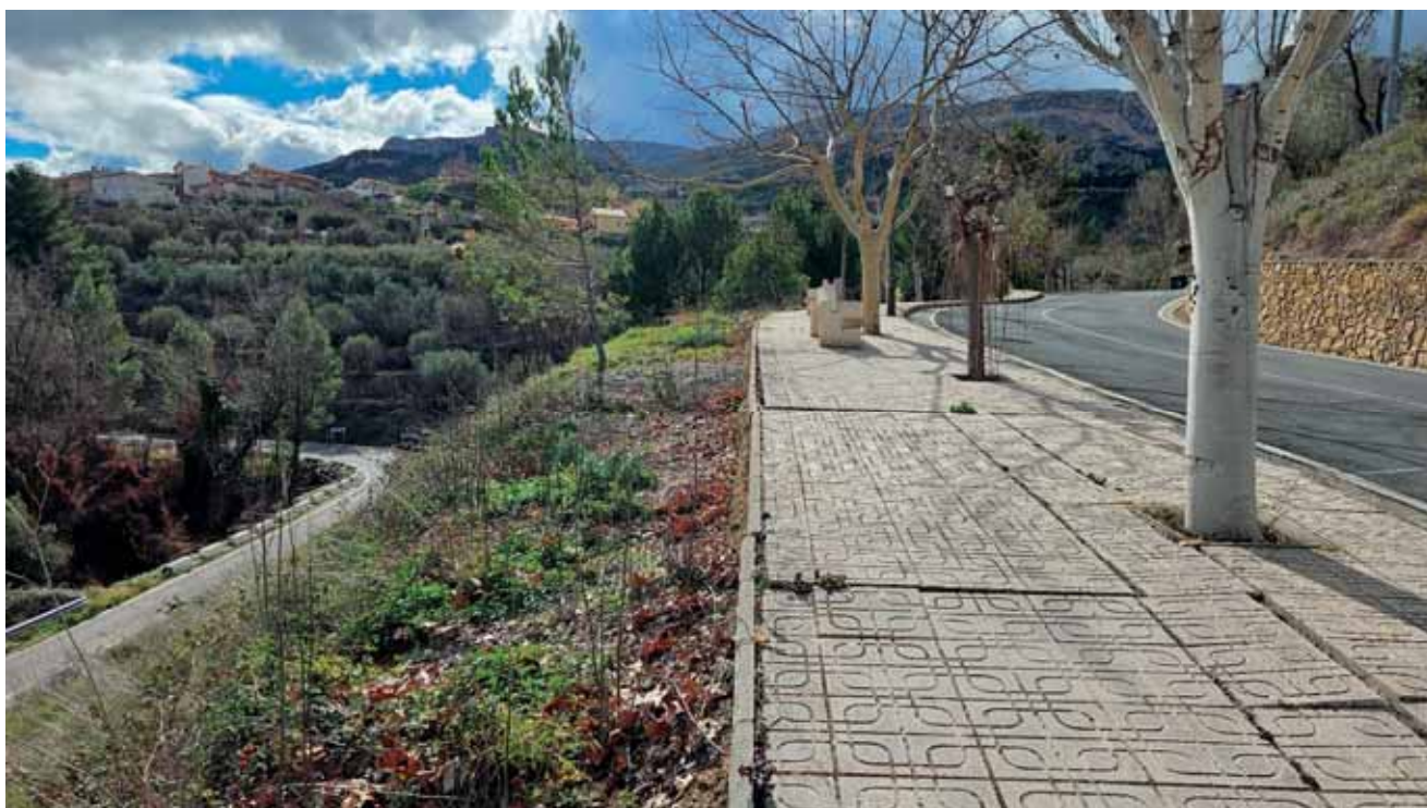
FOTO 8. Vista general de la acera junto a talud existente que provoca desplazamientos del pavimento.
