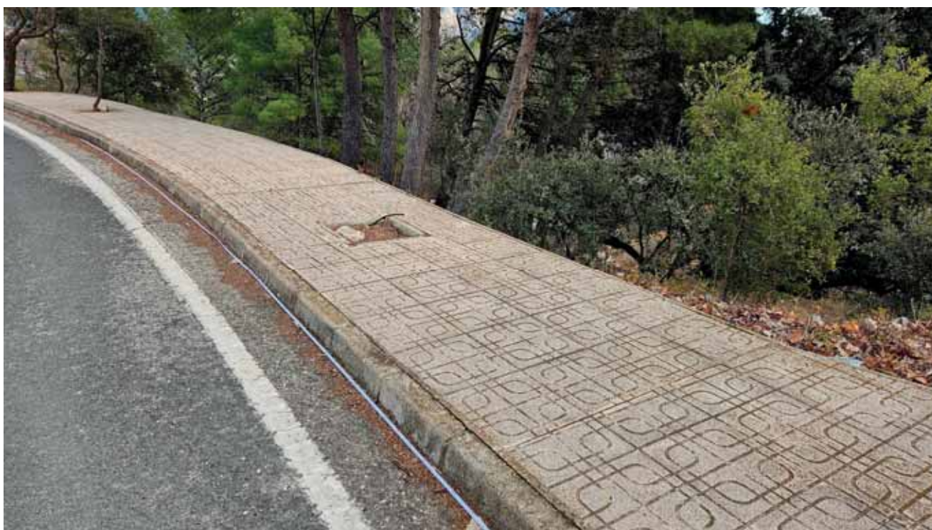
FOTO 4. Estado del pavimento de terrazo. Alcorques sin árboles.
