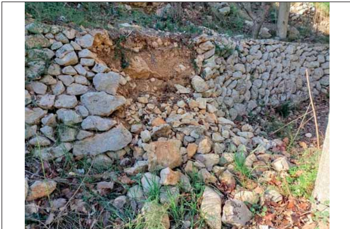
FOTO 05. Derrumbes de muros de mampostería.
