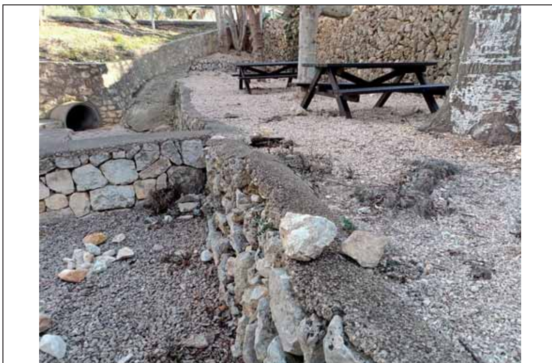
FOTO 12. Muro de mampostería en terraza nº 3. Se proyecta la demolición del hormigón de coronación y la ejecución de un suplemento de 40 cm de muro.
