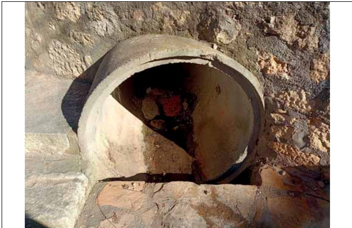
FOTO 04. Tubo de hormigón en solado. Restos de residuos y agua.
