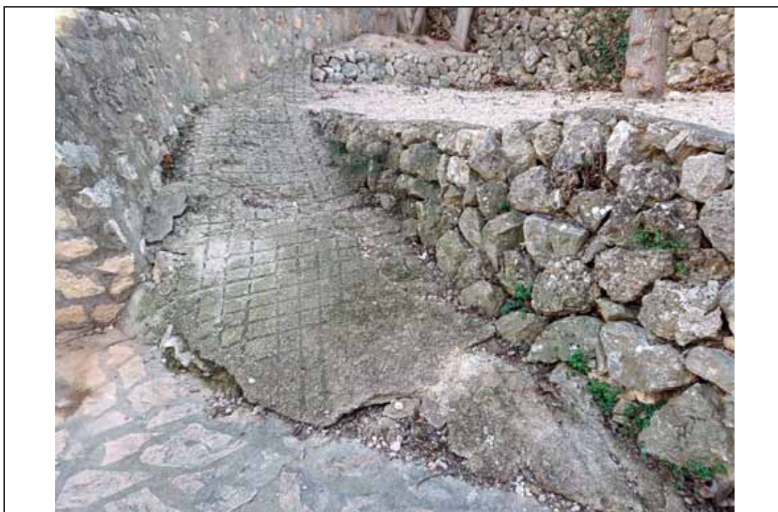
FOTO 10. Rampa de hormigón entre solado y terraza nº 3. Se proyecta ejecución de nuevo acceso mediante escalera.
