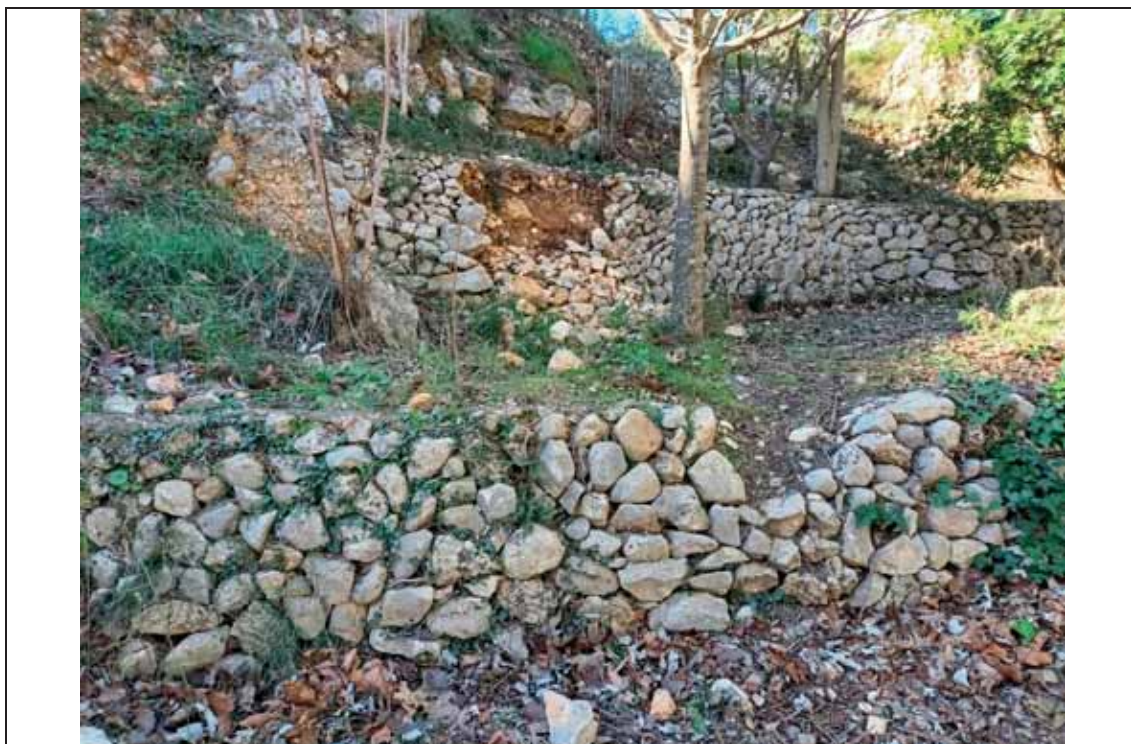
FOTO 06. Derrumbes de muros de mampostería.
