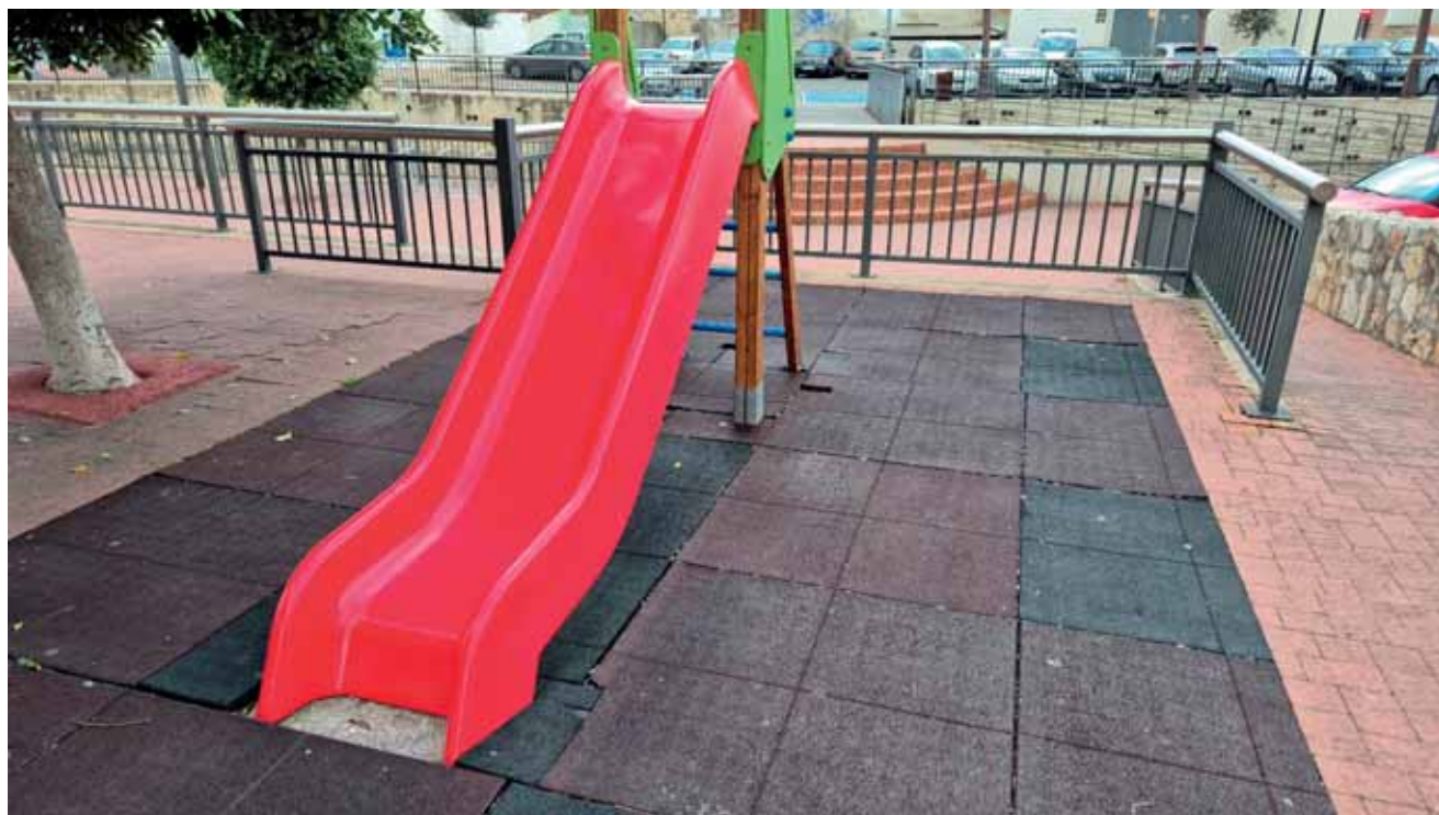
FOTO 7. Vista del estado del tobogán y pavimento de baldosas de caucho.
