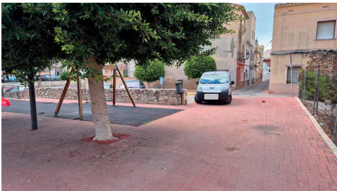
FOTO 4. Estado del pavimento de adoquín en el entorno de los árboles
