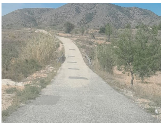
Imagen nº03. Tramo asfaltado con múltiples zonas reparadas.
