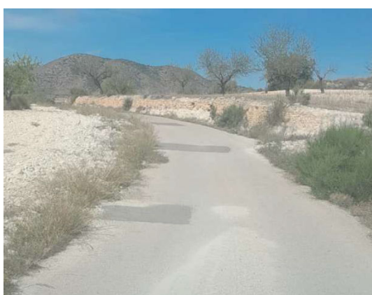
Imagen nº05. Tramo asfaltado con múltiples zonas reparadas.
