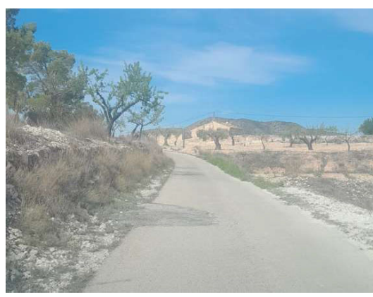
Imagen nº06. Tramo asfaltado con múltiples zonas reparadas.
