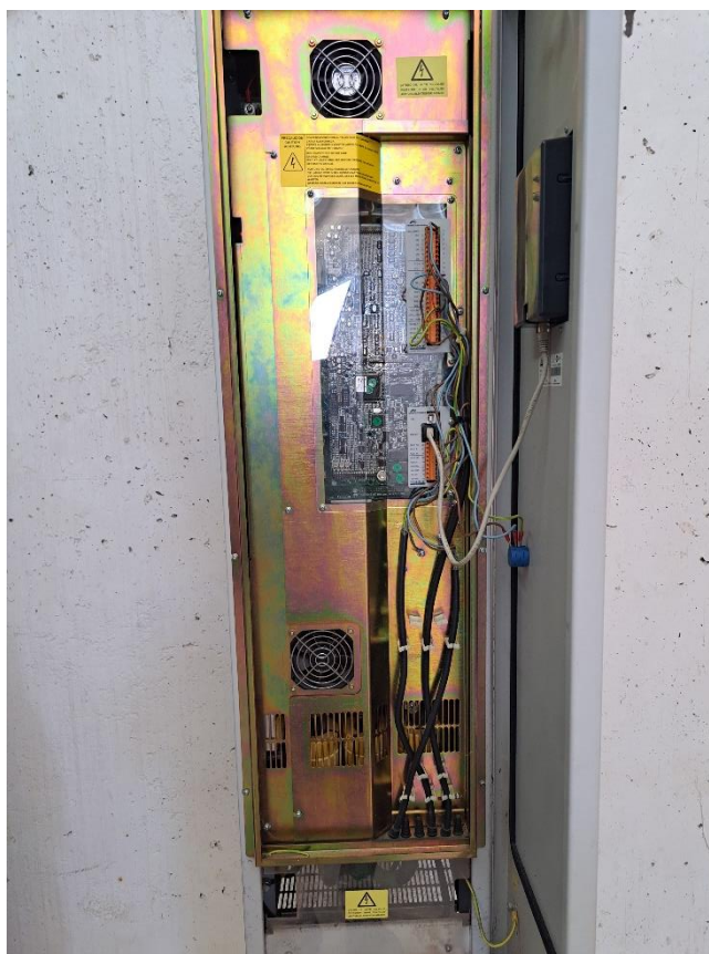
Fotografía 8. Vista del variador de frecuencia existente de 60 kW
