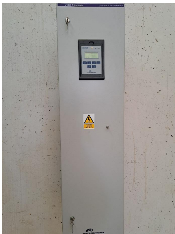
Fotografía 7. Vista del variador de frecuencia existente de 60 kW
