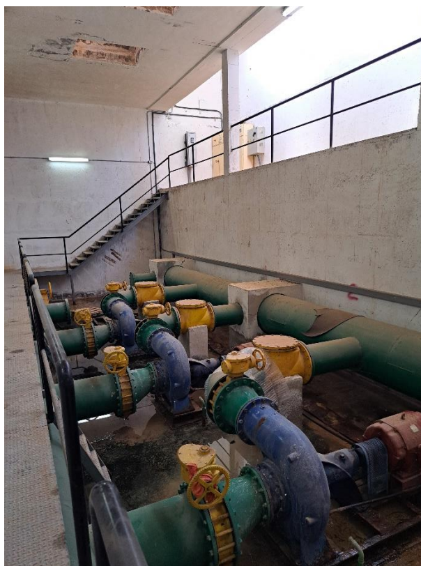
Fotografía 10. Vista del colector de impulsión al Cuarto Canal de Poniente
