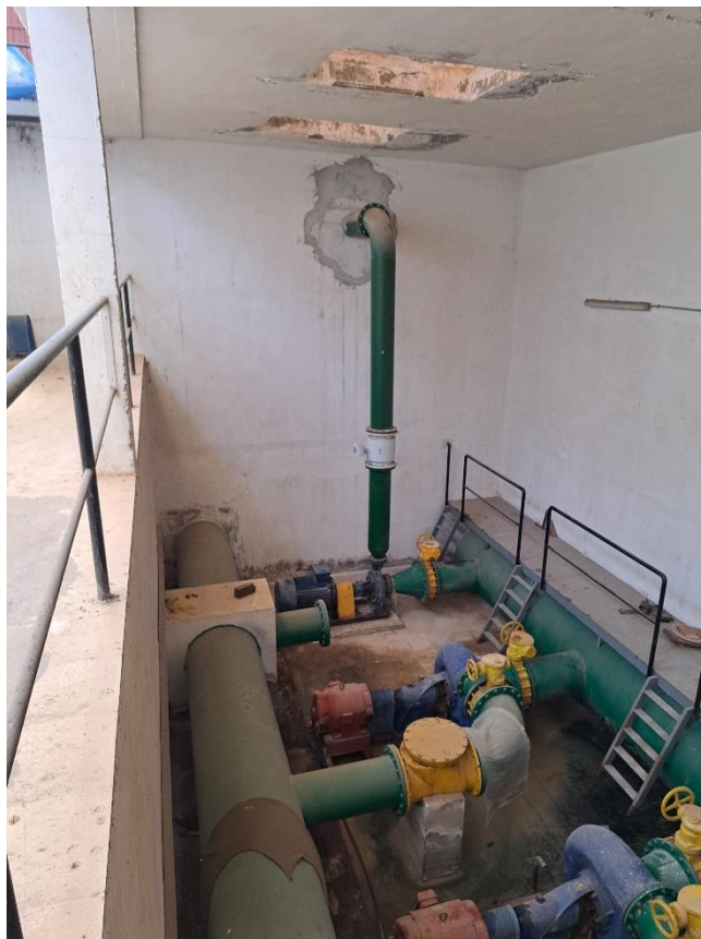
Fotografía 9. Vista de la tubería de impulsión a la zona alta
